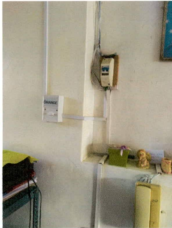
Foto N°21: Instalaciones eléctricas expuestas, no hay tableros eléctricos, las conexiones se realizan por medio de canaletas, existen tomacorrientes en mal estado.
