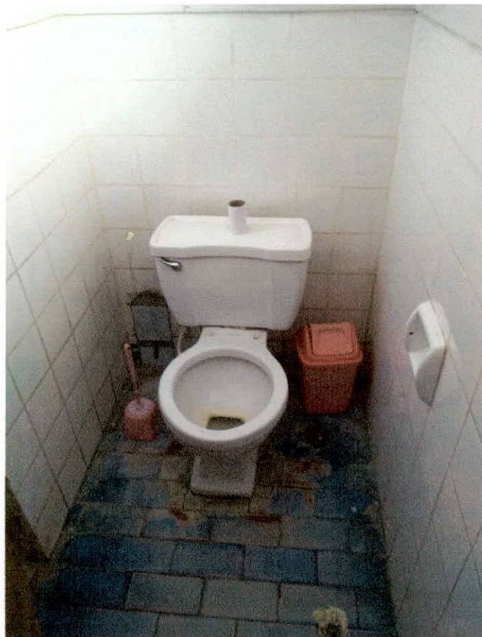
Foto N°13: SS. de docente, cuya área no corresponde a lo normado, su ubicación es incorrecta (dentro de las aulas) y acabados en mal estado.
