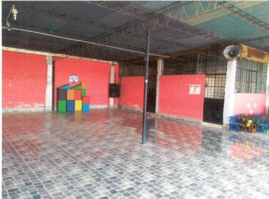
Foto N°23: Vista del acceso al módulo 3, se constata la improvisación de las instalaciones, así como la construcción de los ambientes que no cumplen con las normas de construcción y de seguridad vigentes. Utiliza el techo del patio como parte de su cobertura.
