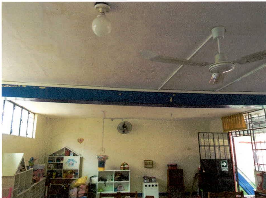
Foto N°19: Se aprecia el pandeo de la viga en el aula común 2, ello debido a la humedad soportada durante el periodo lluvioso del año 2017 y posiblemente a fallas estructurales estructural de la misma.
