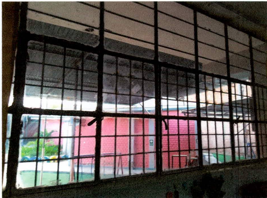
Foto N°22: Puertas y ventanas metálicas con vidrio crudo afectadas por la corrosión ocasionadas por la humedad y el paso del tiempo que, si bien se ha tratado de darles mantenimiento, pueden ocasionar situaciones riesgosas para los alumnos.
