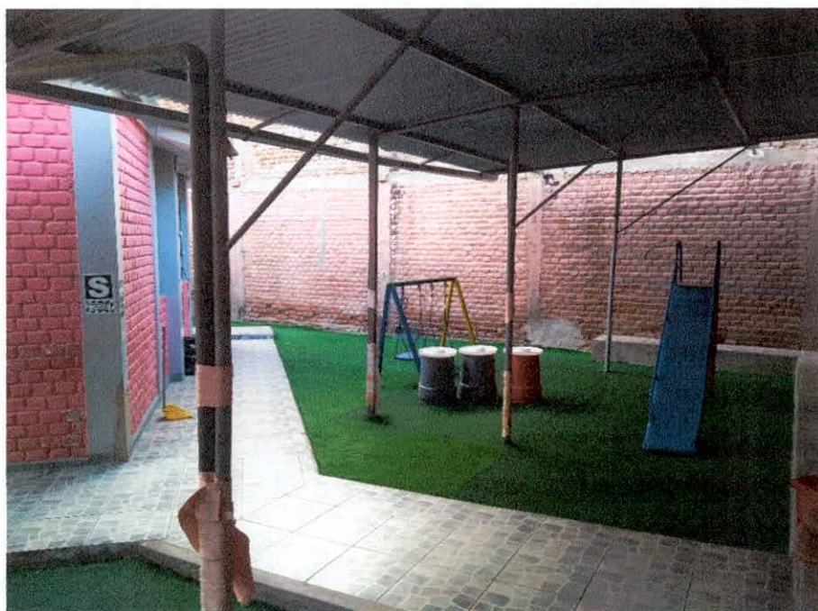
Foto N°20: Aulas exteriores techadas para evitar la radiación solar y las lluvias, cuyas columnas metálicas constituyen un peligro latente para los alumnos.
