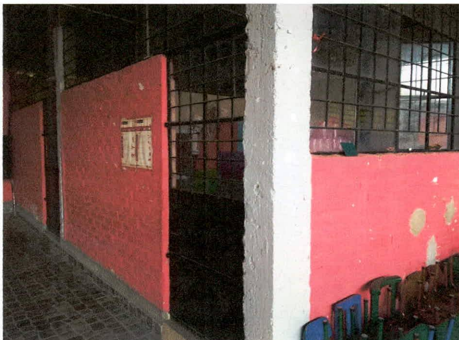
Foto N°24: Se aprecian los daños estructurales en la columna propios de la antigüedad del bloque, la humedad y el mal diseño estructural del mismo.
