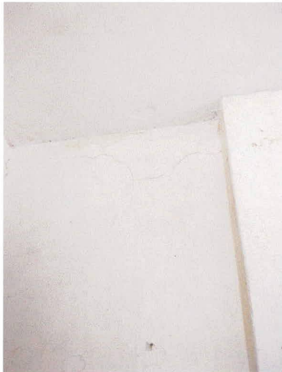
Foto N°05: Fisuras en muro en el encuentro con la losa, en la parte central del módulo.
