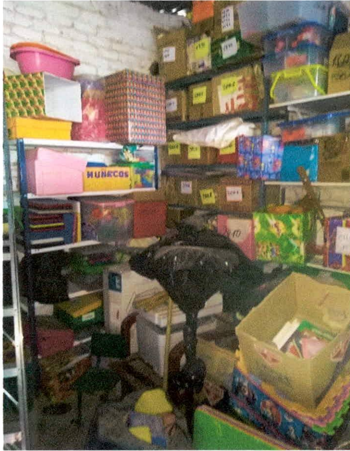
Foto N°25: Vista del SUM AULA DE PSICOMOTRICIDAD totalmente hacinado. Se aprecia también la improvisación de las estructuras del ambiente que no cumplen con las normas vigentes del RNE.
