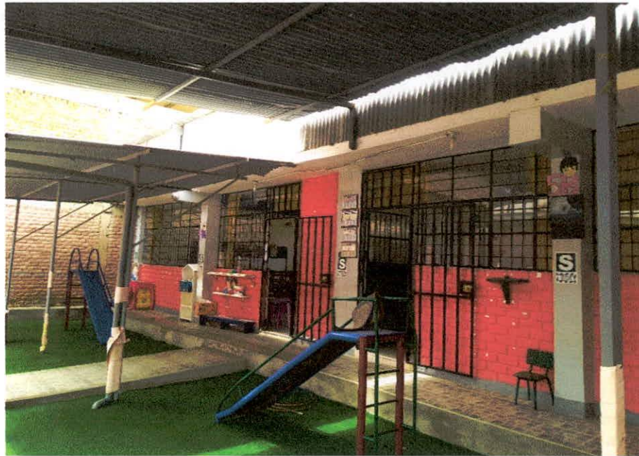
Foto N°17: Vista elevación del módulo 2, cuenta con cobertura liviana en calamina sobre la losa de concreto. Si bien se encuentra con mantenimiento, se puede constatar el deterioro de la estructura.
