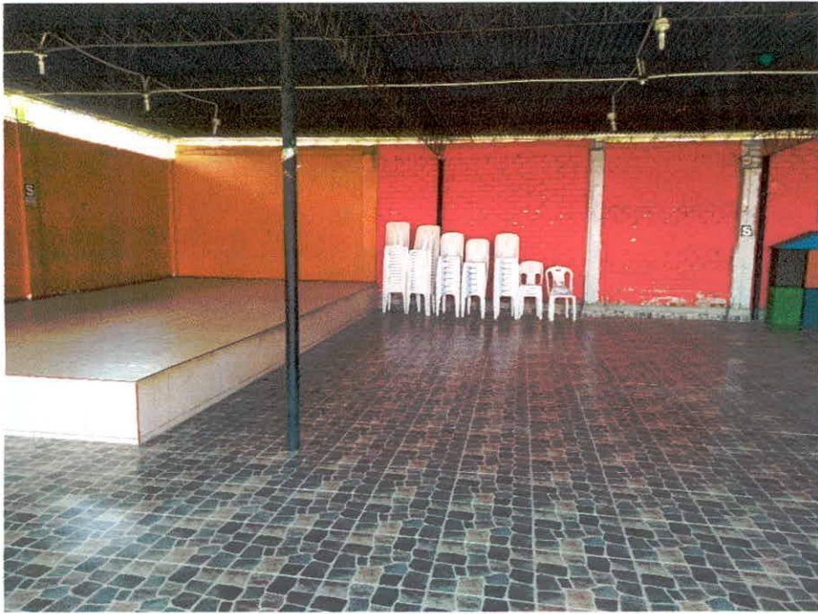
Foto N°29: Vista de la cobertura con estructura metálica tipo calamina y a una altura muy baja que protege el patio de formación de la I.E el cual se apoya sobre el cerco perimétrico, causando mayores problemas estructurales al mismo por no encontrarse confinado. Las columnas metálicas se encuentran a la mitad del mismo pudiendo generar accidentes con los niños. El piso del patio de formación, se encuentra en estado regular de conservación.
