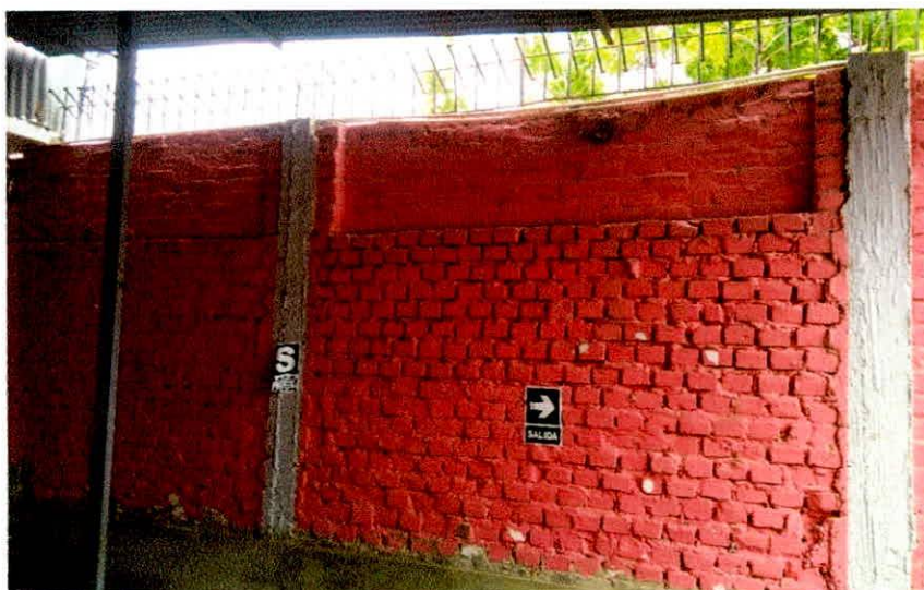
Foto N°28: Se evidencia que parte del cerco perimétrico no cuenta con sistema estructural de confinamiento, lo cual implica un peligro ante cualquier evento sísmico o de lluvias, por lo que la base del mismo, se encuentra afectada por el empozamiento del agua de lluvias.
