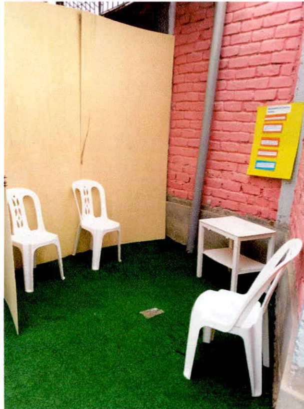
Foto N°31: Sala de Espera con materiales precarios (triplay) para la recepción de padres de familia antes de ingresar a la Dirección del plantel educativo, no cumple con las áreas y condiciones mínimas estipuladas en el reglamento.
