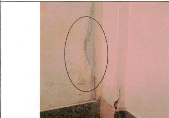
FOTO N° 20: deterioro en muro de albañilería, presencia de sulfatos y desprendimiento de pintura en dicho muro, MODULO N° 01
