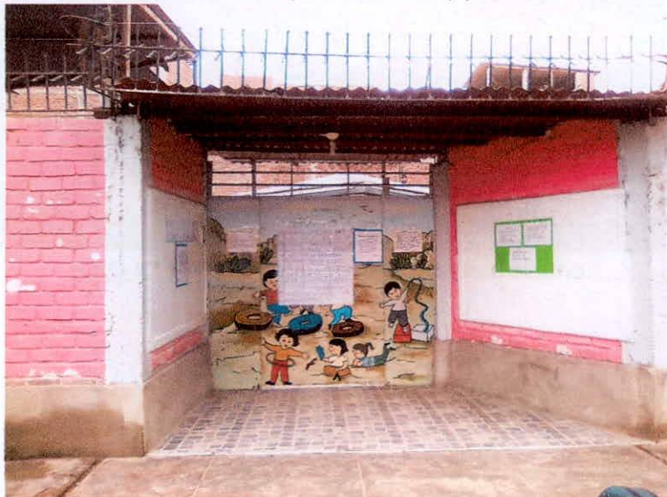
FOTO N° 09: Estado actual de Portada de Ingreso Principal.
