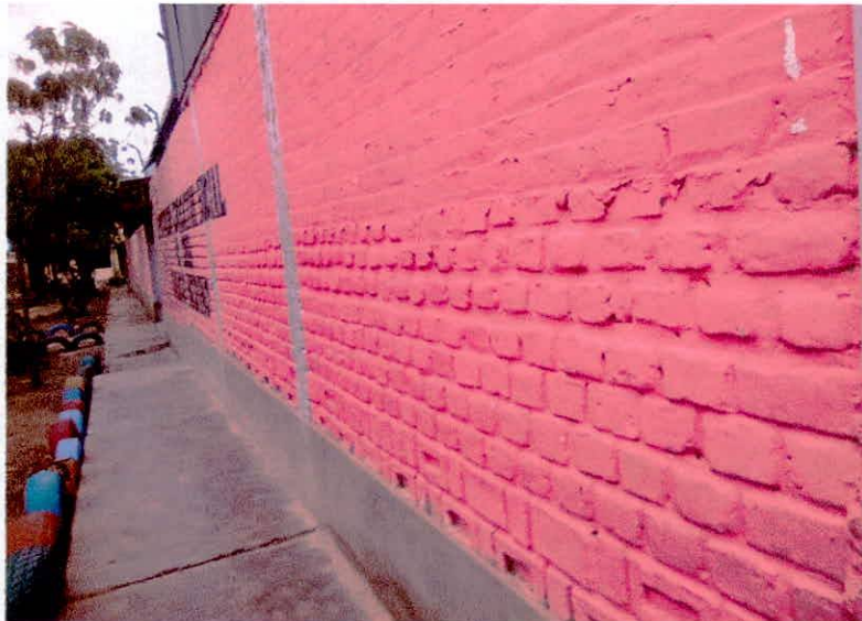
FOTO N° 12: Vista del cerco perimétrico desde el lado derecho, se puede visualizar el diverso asentado de ladrillo.
