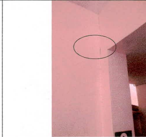
FOTO N° 19: Fisura en la unión de columna con Muro de albañilería, MODULO N° 01
