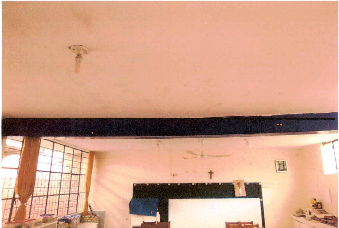
FOTO N° 05: Viga deformada, flexión máxima, posible falla de acero.
