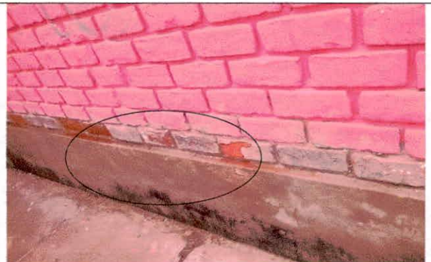
FOTO N° 21: Desgaste de las unidades de albañilería, se visualiza la filtración a consecuencia de las lluvias en el exterior.
