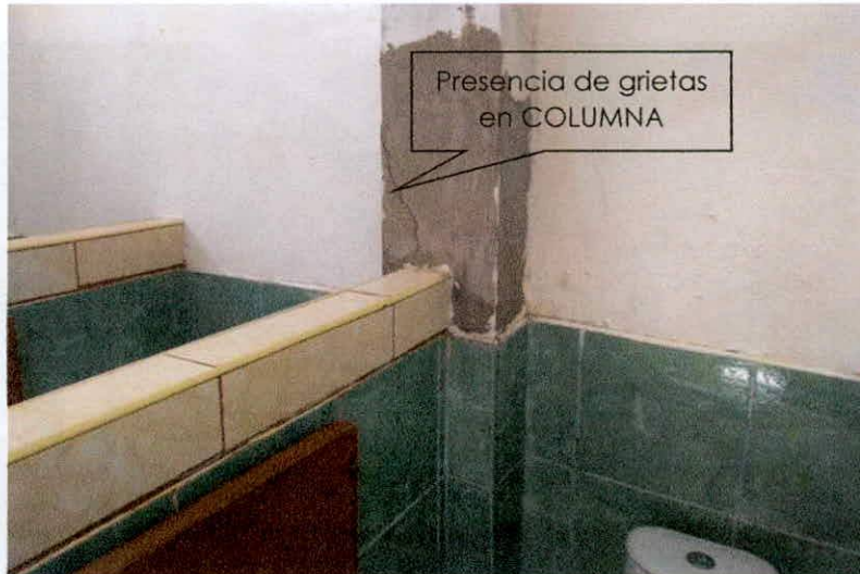
FOTO N° 08: grietas en columna, Modulo de Ss. Hh de niñas. De la visualización tenemos las siguientes características:
