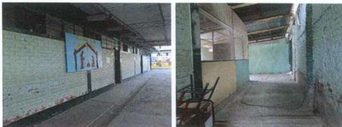
ESTADO ACTUAL DE LOS MUROS DE AULAS CONSTRUIDOS CON LADRILLO ARTESANAL
