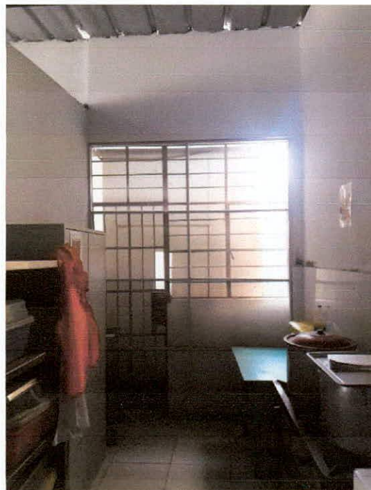
Foto N°13: Vista de la cocina, Se verifica que no cumple las condiciones técnicas para ofrecer la dispensa de alimentos a los niños.
