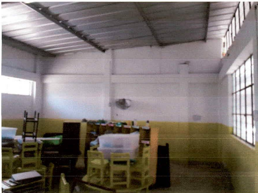
Foto N°07: Vista del interior de un aula en el Módulo B, se aprecia las dimensiones de los vanos del aula, con materiales desgastados e inseguros como el vidrio crudo, marco metálico antiguo.
