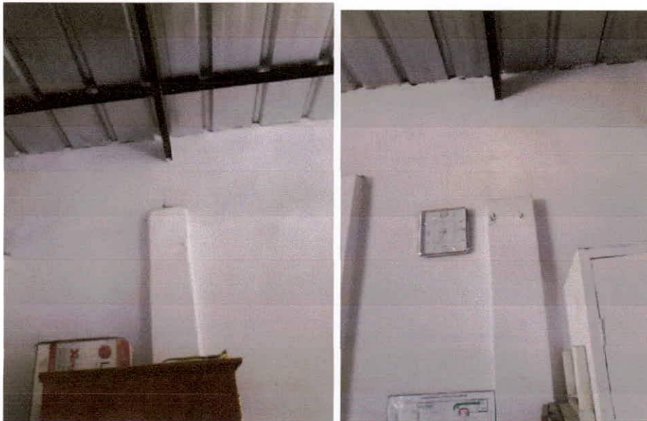
Foto N°10 y 11: Vista el fisuramiento de las estructuras de soporte de la cobertura, lo cual constituye peligro de desplome ante cualquier evento, así mismo se evidencia la discontinuidad de las columnas.
