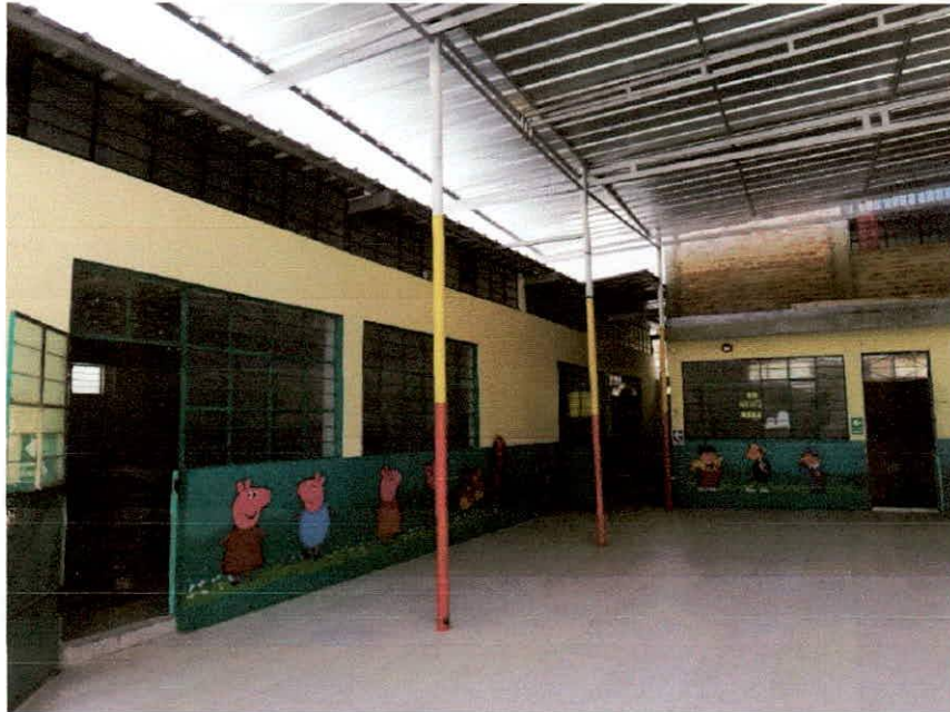
Foto N°06: Vista elevación del Módulo B, la instalación de la cobertura liviana la realizó la APAFA dado que en el fenómeno del año 2017 las instalaciones se inundaron, podemos ver que se puede presentar la columna corta, así mismo no cuenta con junta sísmica en ninguna parte de la estructura.
