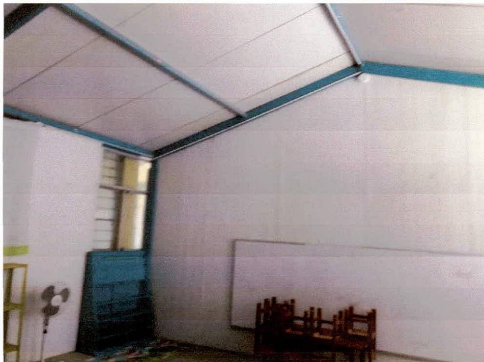
Foto N°16 y 17: Vista del aula prefabricada en su interior con una antigüedad de 5 años, deberá reemplazarse por una estructura de material noble y acorde con las normas actuales.
