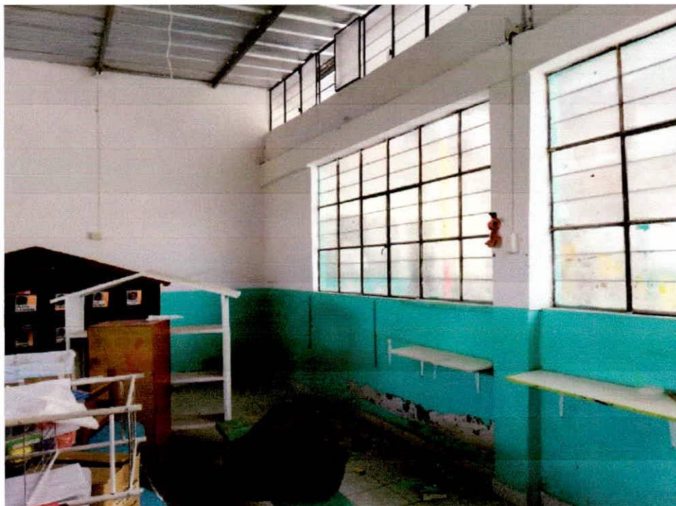
Foto N°08: Vista en elevación del Módulo B, se aprecia que no se cuentan con juntas sísmicas en su estructura, así mismo se puede apreciar que se puede dar el efecto de columna corta en la estructura.
