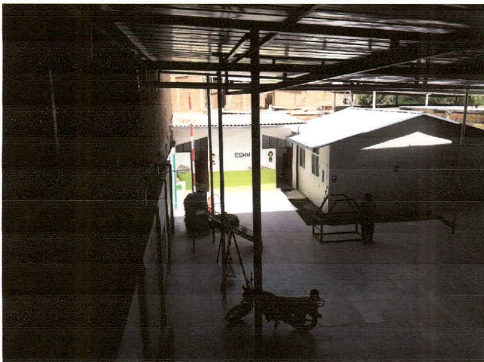
Foto N°23 y 24: Vista de la zona junto al módulo E y D donde falta cobertura con estructura metálica, donde ingresan agua pluviales y que perjudican el mobiliario y el estado de las estructuras existentes.
