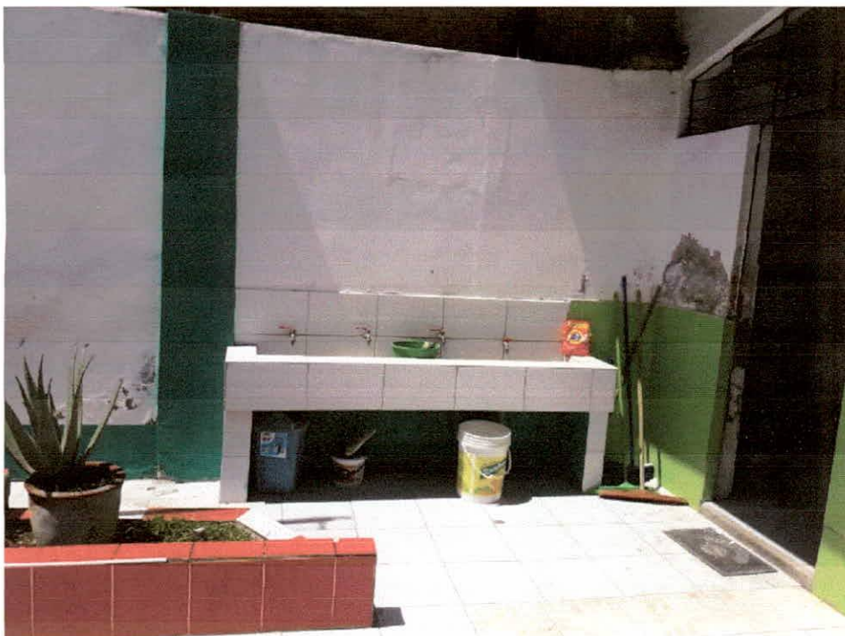
Foto N°21: Vista a más detalle del estado actual de los lavatorios hacia el exterior, el cual se evidencia el desgaste de los materiales, por efectos de las lluvias.
