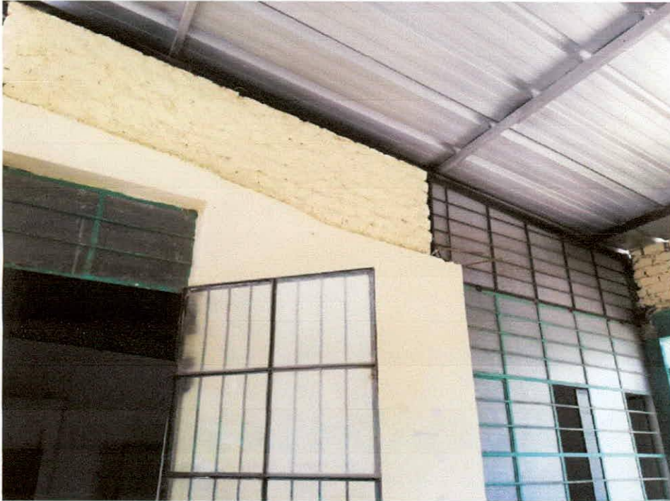
Foto N°12: Vista de la falta de continuidad de estructuras de confinamiento, lo cual constituye peligro de desplome ante cualquier evento, así mismo se evidencia la discontinuidad de las columnas.
