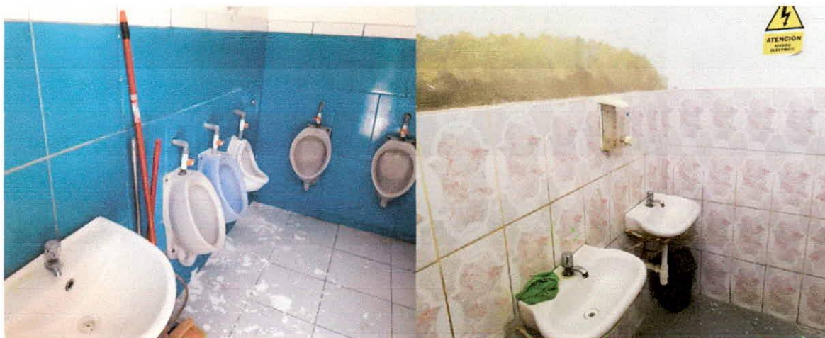
Foto N°19 y 20: Vista del interior de los servicios higiénicos, se verifica el desgaste de los materiales de acabados, los espacios no cumplen las normas vigentes para su uso.
