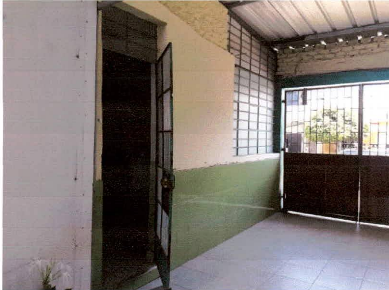
Foto N°9: Vista elevación del Módulo C, cuenta con cobertura liviana de Calaminon TR4. Si bien se encuentra con mantenimiento, se puede constatar el deterioro de la estructura.
