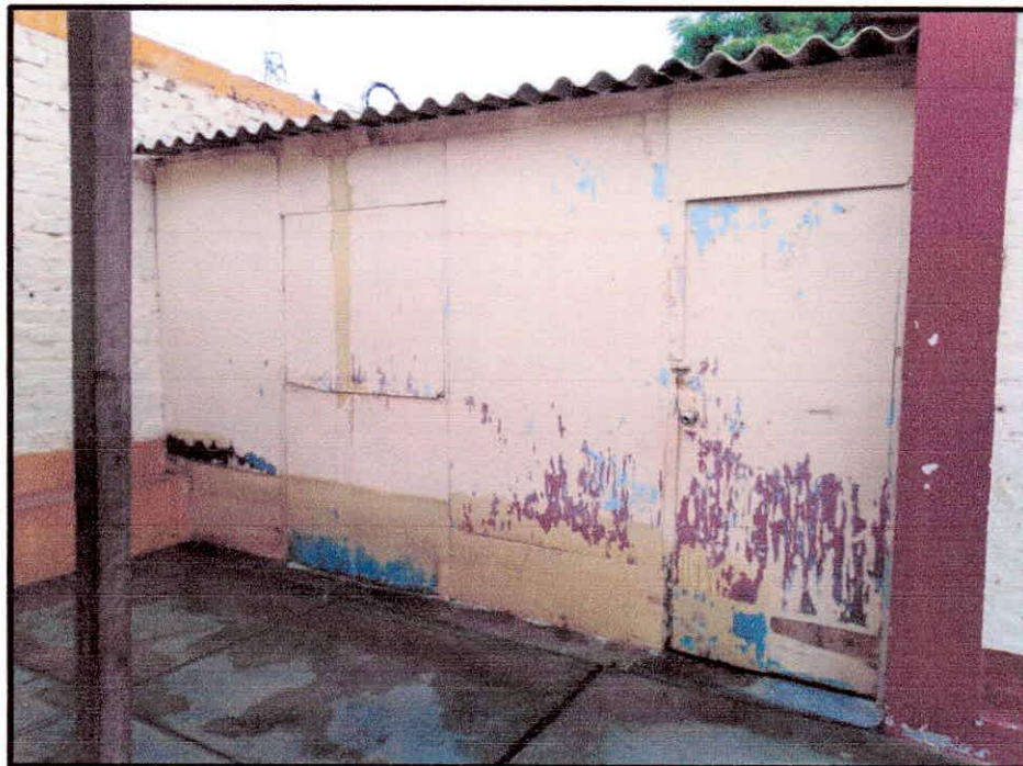
FOTO N°09.- Se observa el deterioro del kiosko.
