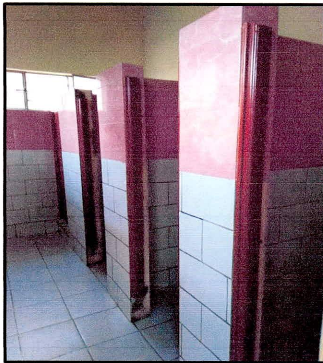
FOTO N°08.- Se observa el interior de los servicios higiénicos de la I.E.
