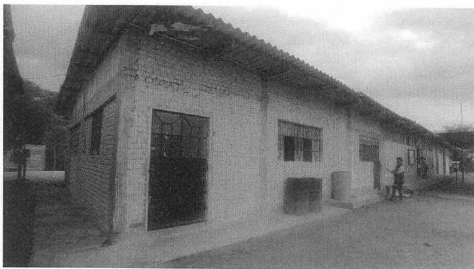
FOTO 5.-AULAS DE PRIMARIA CONSTRUIDAS POR AUTOCONSTRUCCIÓN. PUEDE VERSE EL LADRILLO ARTESANAL Y LAS COLUMNAS AFECTADAS POR LA HUMEDAD DE LA LLUVIA.
