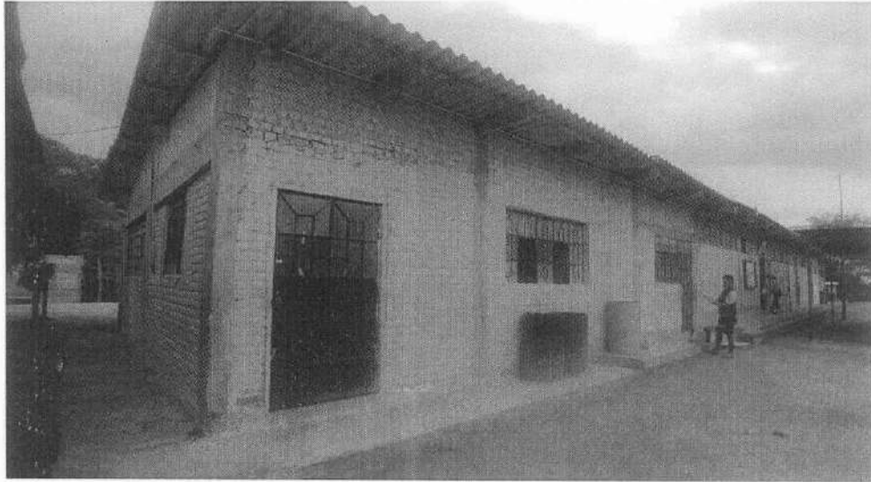
FOTO 5.- SE MUESTRA LAS AULAS DE PRIMARIA CONSTRUIDAS POR AUTOCONSTRUCCIÓN. PUEDE VERSE EL LADRILLO ARTESANAL Y LAS COLUMNAS AFECTADOS POR LA HUMEDAD DE LA LLUVIA.
