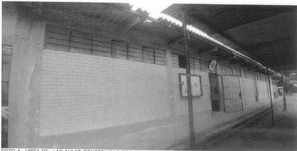
FOTO 4.- VISTA DE LAS AULAS CONSTRUIDAS POR FONCODES EL AÑO 1993. SE VE LA COBERTURA DETERIORADA. VEMOS TAMBIÉN EL PATIO DE SECUNDARIA CON POSTES Y VIGAS SOLERAS METALICOS CON COBERTURA.
