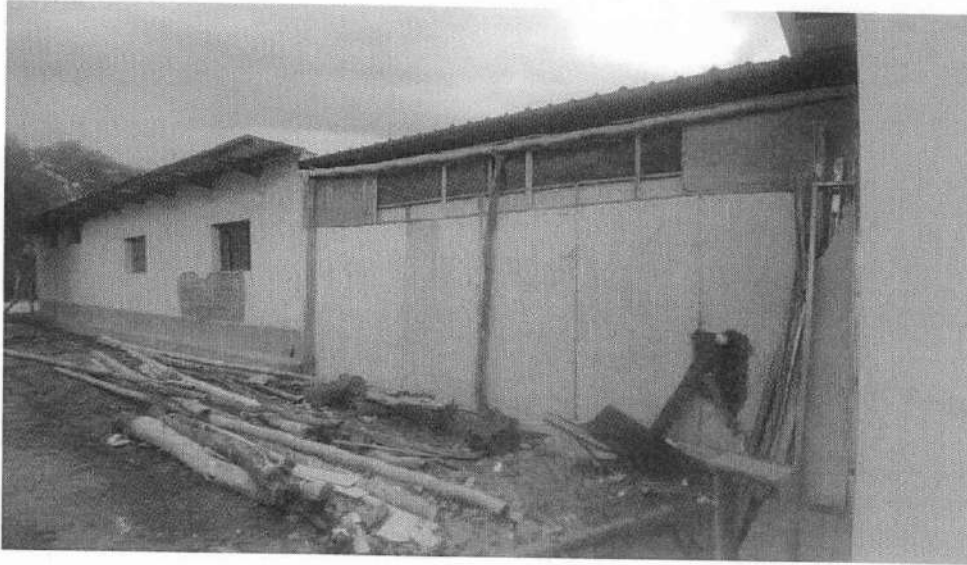
FOTO 8.- VISTA POSTERIOR DEL BLOQUE 2 PUEDE VERSE EL AULA Y EL CRA CONSTRUCCIONES DE ADOBE Y EL AULA PRIMARIA CONSTRUIDA CON PLANCHA DE CARTON YESO. LA LLUVIA DEL MES DE FEBRERO HA HECHO QUE SE RETIRE PARTE DEL TARRAJEO DEL MURO DE ADOBE Y LA HUMEDAD AFECTO EL TABIQUE DEL AULA.
