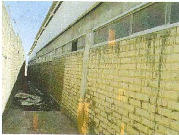
BLOQUE M-01 SE VE LOS MUROS POSTERIORES DE LADRILLO ARTESANAL DETERIORADOS POR LA HUMEDAD.
