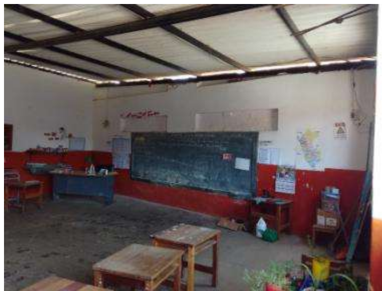
Foto N° 2: Vista al interior del aula (MODULO 01), se aprecia cableado sin empotrar en los muros, muros sin vigas de confinamiento, escasez de luminaria y tomacorrientes.
