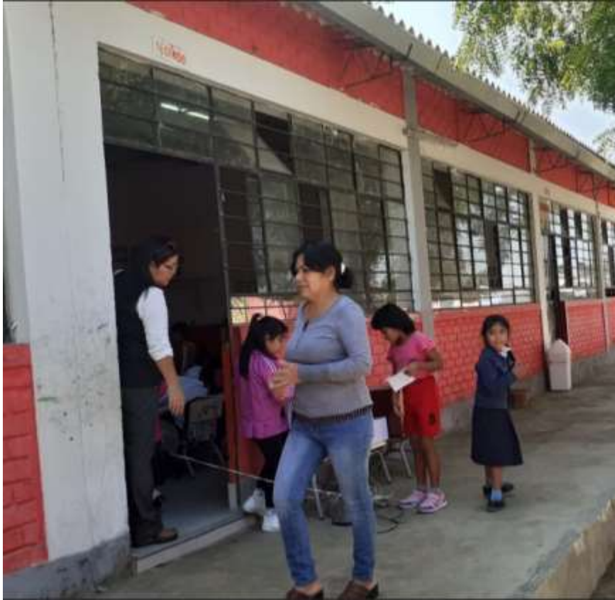
Foto N° 9: Vista de elevación frontal se aprecia el módulo del aula de 2do grado (MODULO 5), con puertas y ventanas metálicas, algunas sin vidrios, las paredes en el exterior cuentan con un recubrimiento de pintura que está en estado regular en los sobrecimientos, muros y columnas. El piso interior es de cerámica blanca, y la vereda de circulación es de cemento pulido las cuales se han levantado debido a las raíces de los árboles que se encuentran cerca.
