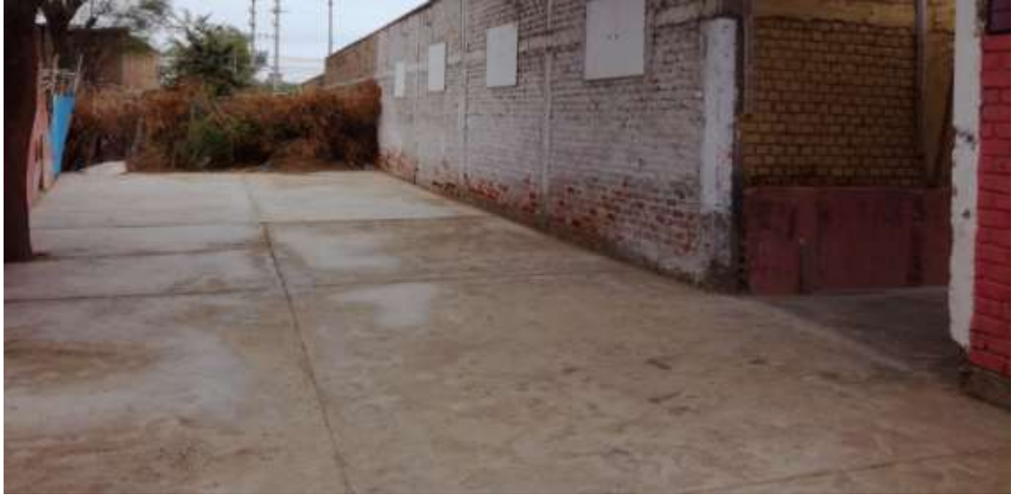
Foto N°34: Losa de patio: deteriorada por la abrasión y presencia de fisuras, debilitamiento a nivel de base y sub base por presencia de lluvias e inundaciones, ya que carece de un sistema de drenaje.
