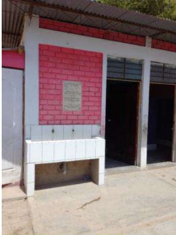
Foto N° 18: Vista del lavatorio en los exteriores de los baños, donde carece de accesorios para los puntos de agua.
