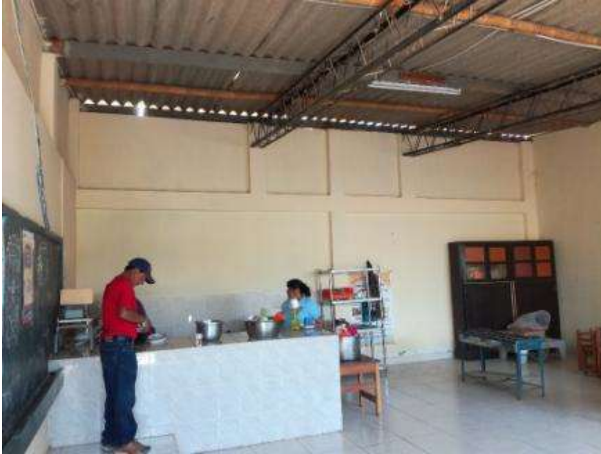
Foto N° 12: Vista al interior del modulo que funciona como cocina comedor, se patenta la falta de un sistema de ventilación, desagüe, agua por el sistema indirecto, etc. Además, carece de mesas y sillas para la recepción del alumnado.
