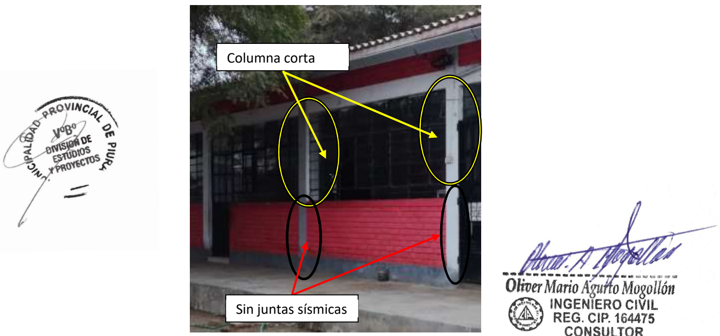
Foto N° 7: Vista de elevación frontal se aprecia el módulo del aula de 1er grado (MODULO 4), con puertas y ventanas metálicas, algunas sin vidrios, las paredes en el exterior cuentan con un recubrimiento de pintura que está en estado regular en los sobrecimientos, muros y columnas. Existe cableado externo expuesto.
