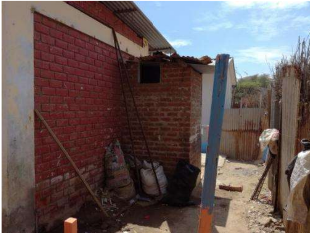
Foto N° 16: Vista en la parte trasera de los servicios higiénicos destinado para los profesores, se aprecia presencia de humedad en los muros, falta de vigas y columnas para confinar los muros, falta de ductos de ventilación, el techo es totalmente inadecuado.
