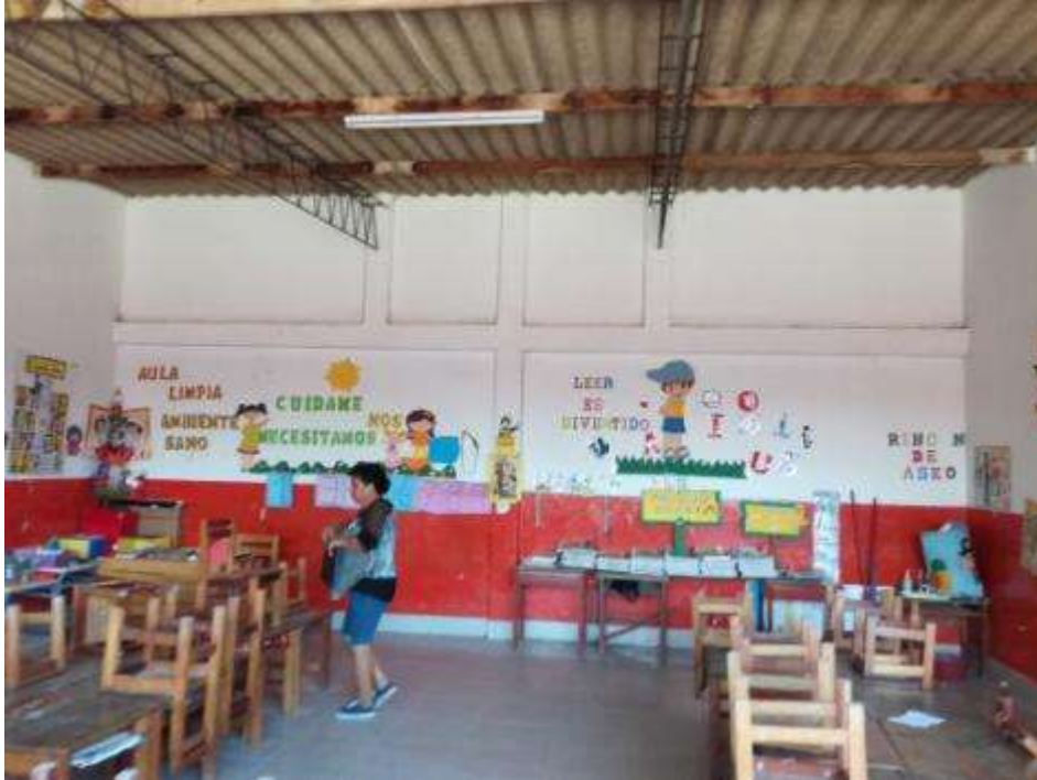
Foto N° 8: Vista al interior del aula de 1er grado (MODULO 4), muros sin vigas de confinamiento.
