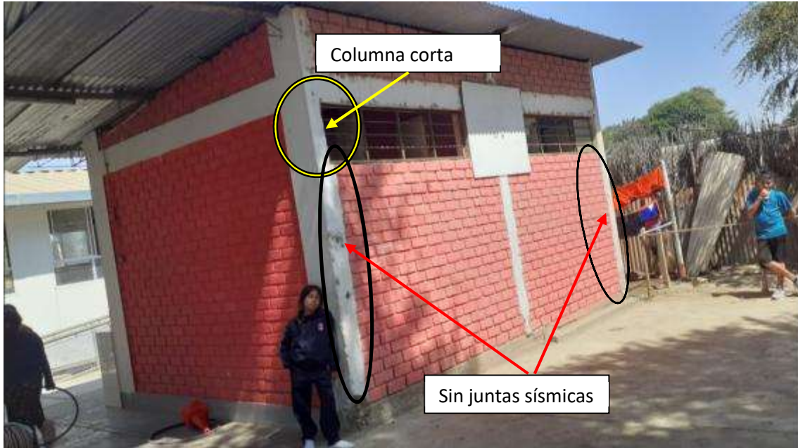
Foto N° 14: Vista anterior de los MODULOS 7 y 8, se puede apreciar la carencia de un sistema de drenaje, carencia de un adecuado sistema de ventilación. Columna deteriorada en su parte inferior, una luna rota para el baño de los varones. Muros sin confinar en la parte superior.
