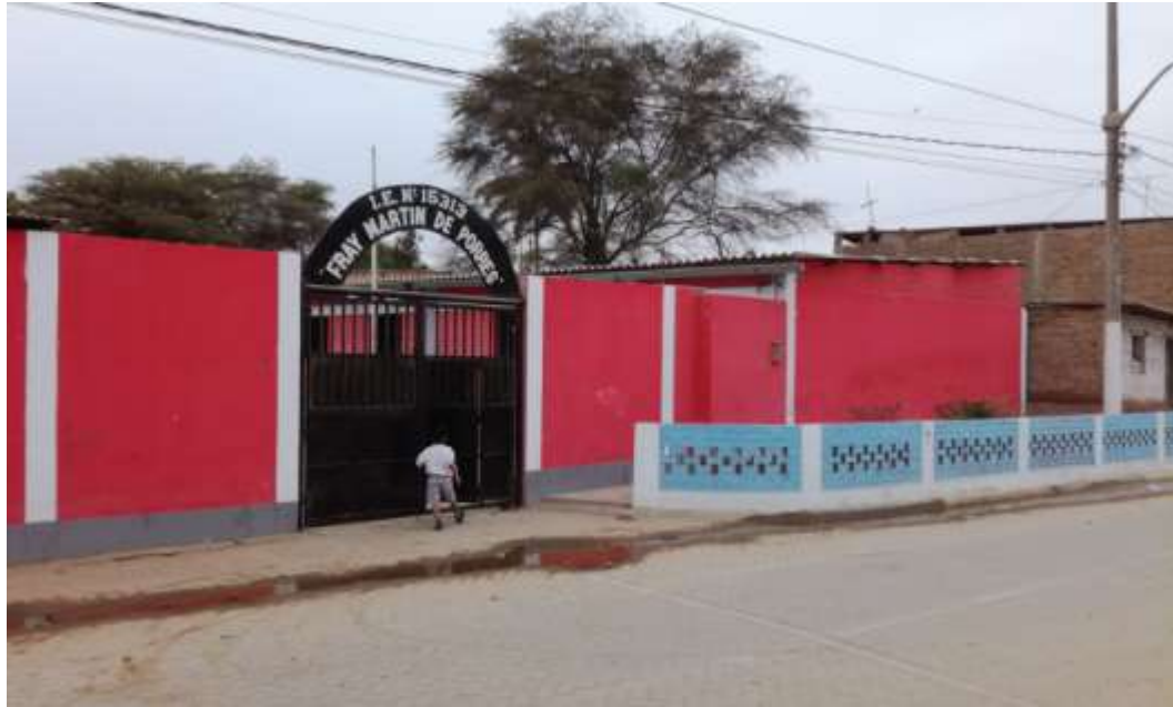
Foto N°28: Vista de la parte delantera del cerco, se aprecia carencia de vigas de confinamiento, señalización, etc.
