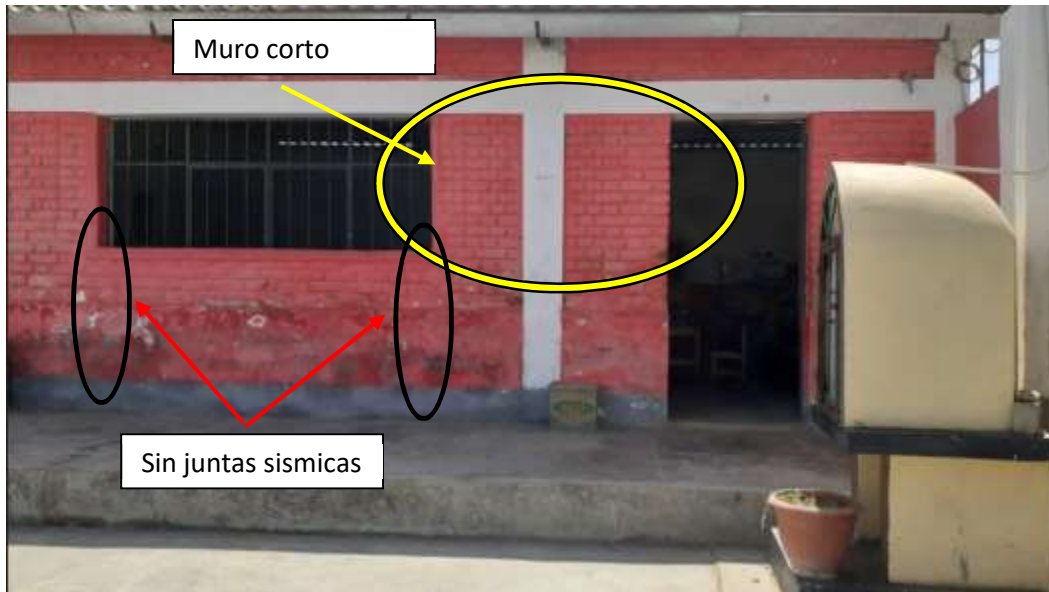
Foto N° 1: Vista de elevación frontal se aprecia el módulo del aula de 3er grado (MODULO 1), con puertas y ventanas metálicas sin vidrios, las paredes en el exterior cuentan con un recubrimiento de pintura que ya agotó su periodo de vida.
