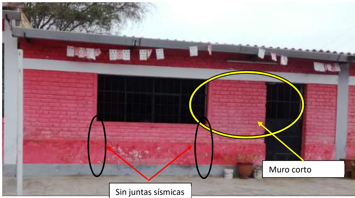
Foto N° 3: Vista de elevación frontal se aprecia el módulo del aula de 6to grado (MODULO 2), con puertas y ventanas metálicas sin vidrios, las paredes en el exterior cuentan con un recubrimiento de pintura que ya agotó su periodo de vida. La luminaria exterior se encuentra deteriorada.
