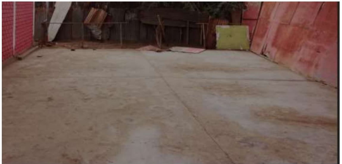
Foto N°33: Losa de patio: deteriorada por la abrasión y presencia de fisuras.
