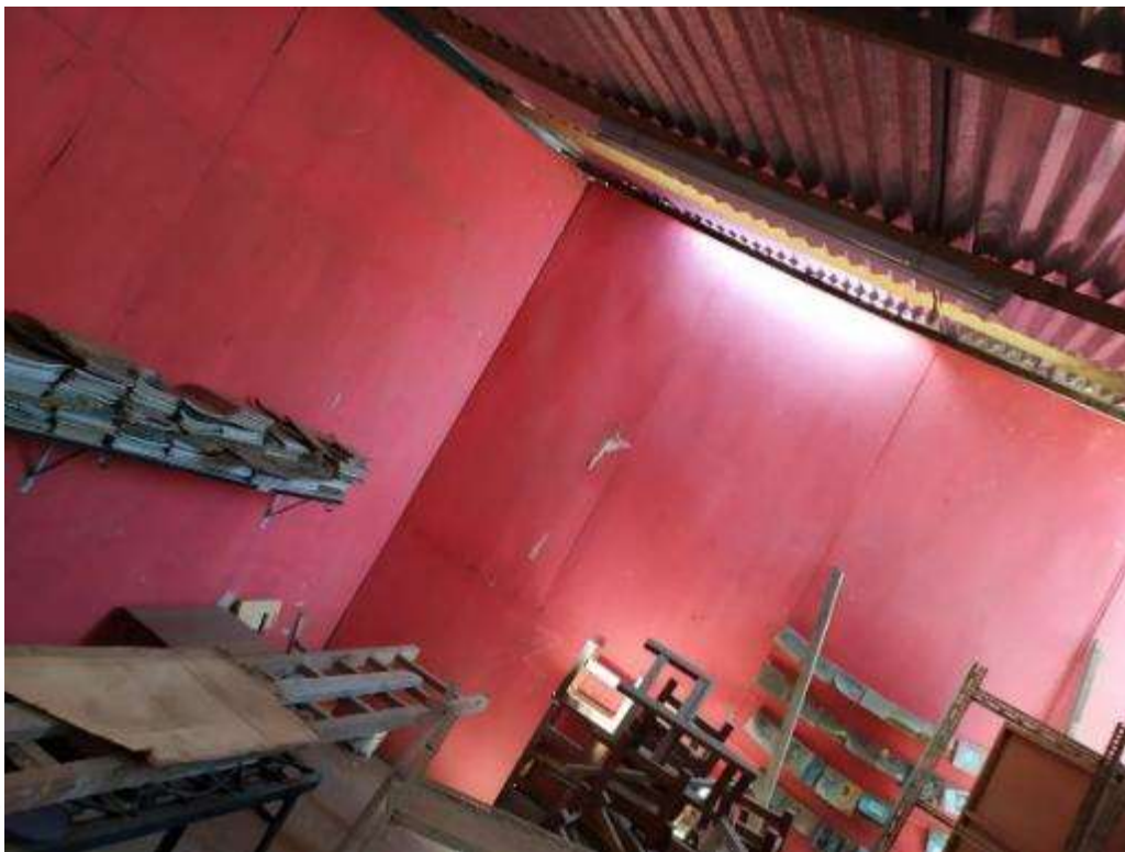
Foto N° 23: Vista interior del aula destinada para lectura (Modulo 11). No cumpliendo con el más mínimo requisito para tal fin.
