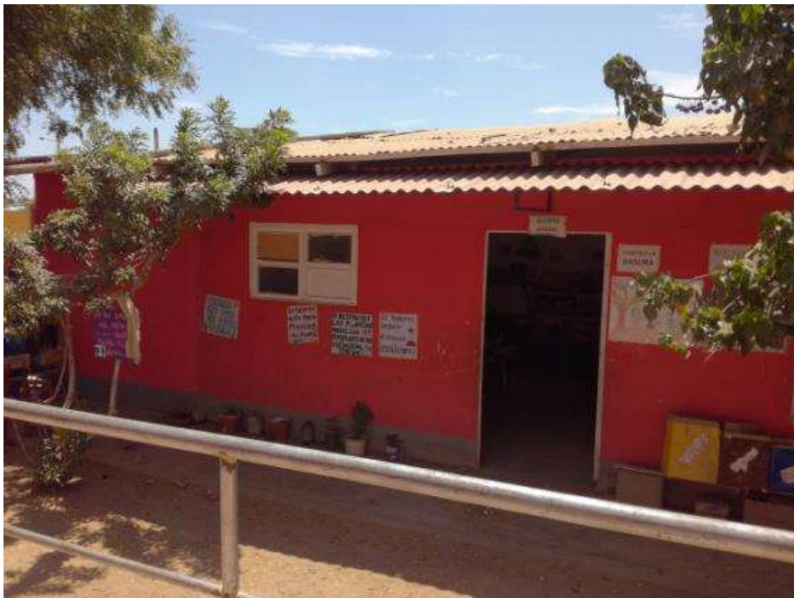
Foto N° 24: Vista frontal del modulo que funciona como aula de 5to grado (MODULO 12), se aprecia la falta de ventilación, iluminación, evacuación pluvial, etc. No dando un ambiente de confort para las actividades de enseñanza y aprendizaje.
