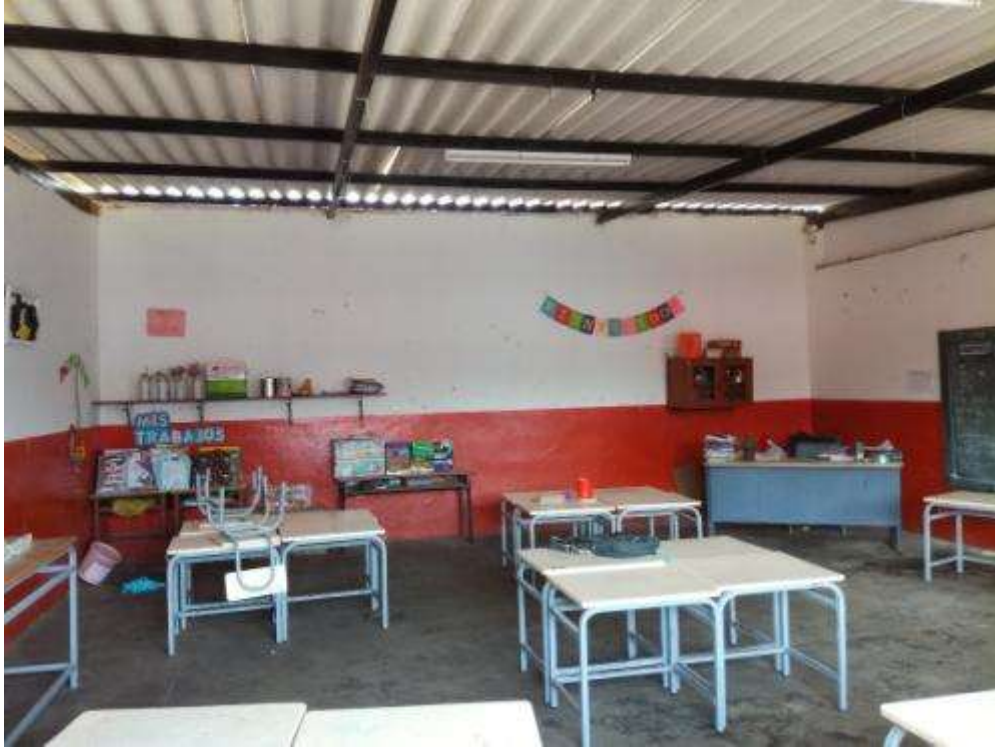
Foto N° 4: Vista al interior del aula (MODULO 02), muros sin vigas de confinamiento, escasez de luminarias y tomacorrientes.
