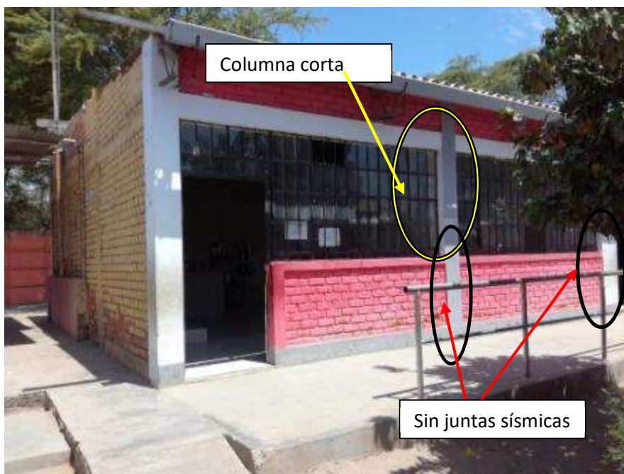
Foto N° 11: Vista de elevación frontal se aprecia el módulo del comedor (MODULO 6), con puertas y ventanas metálicas, algunas sin vidrios, las paredes en el exterior cuentan con un recubrimiento de pintura que está en mal
