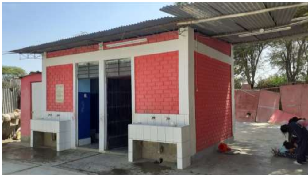
Foto N° 13: Vista frontal de los MODULOS 7, 8 y 9, se puede apreciar la carencia de un sistema de drenaje, carencia de un adecuado sistema de ventilación. La falta de un abastecimiento de agua por el sistema indirecto, teniendo un suministro de agua precario.
