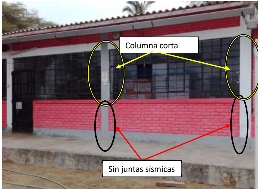
Foto N° 5: Vista de elevación frontal se aprecia el módulo del área administrativa destinada a la dirección (MODULO 3), con puertas y ventanas metálicas, algunas sin vidrios, las paredes en el exterior cuentan con un recubrimiento de pintura que ya agotó su periodo de vida en los sobrecimientos. La luminaria exterior se encuentra deteriorada y mal colocada.
