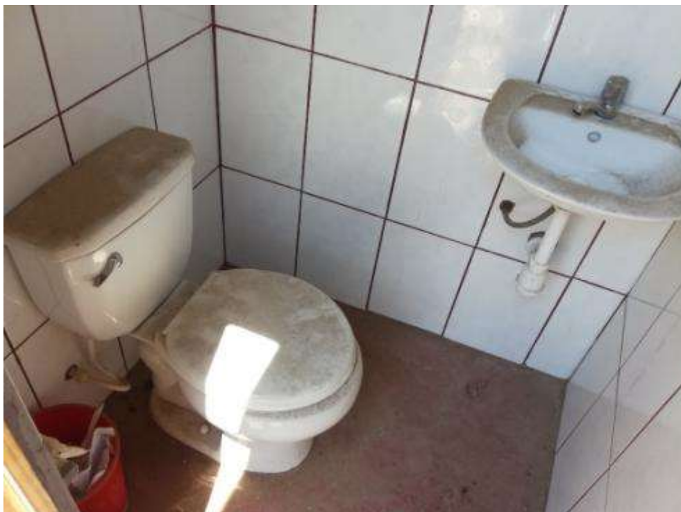
Foto N° 17: Vista interior del baño para docentes (MODULO 9) donde se aprecia los aparatos sanitarios en un área inadecuada, además del deterioro de estos.
