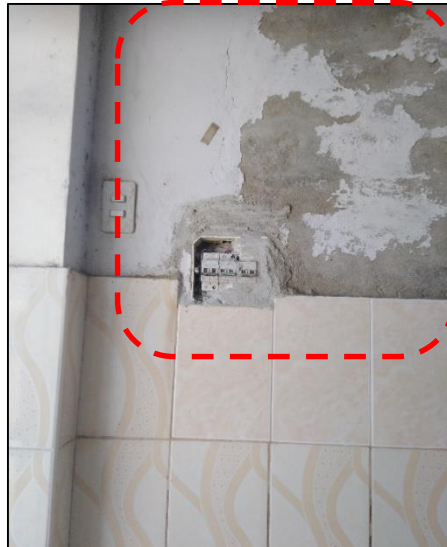
Foto N°06: En la parte interna se aprecia el desprendimiento de la pintura en los muros producto de haber la humedad del muro durante la inundación.
