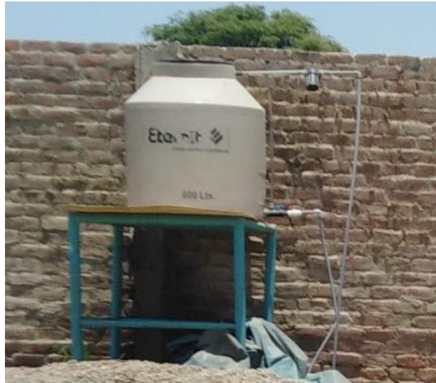
FotoN°16: El tanque elevado 03 es de estructura metálica y el contenedor es de polipropileno. Su estado es regular. Fue adquirido por la APAFA.
