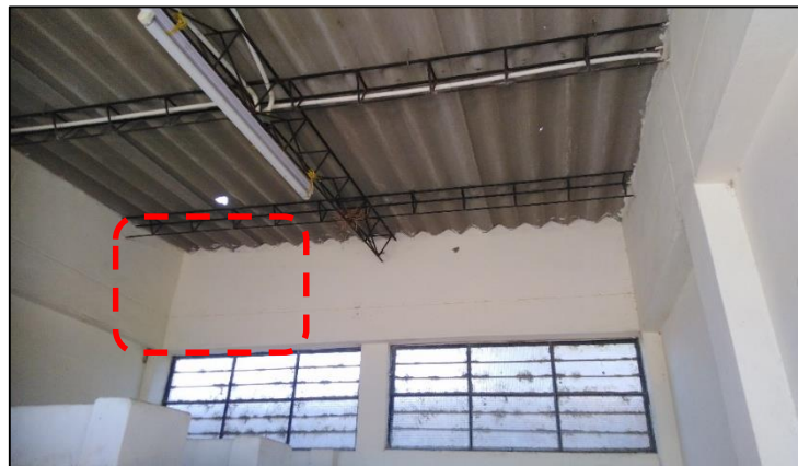
Foto N°07: Las coberturas presentan agujeros.
