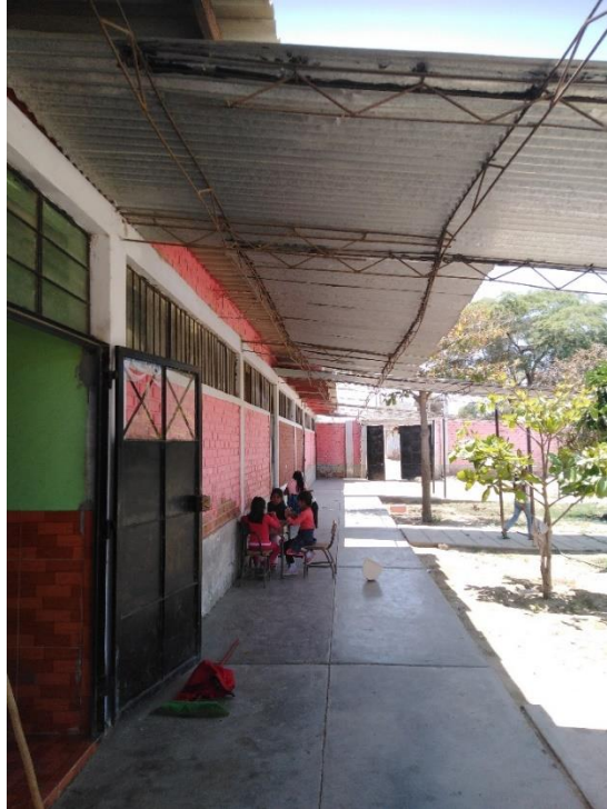
FotoN°12: Presenta deterioro por eventos de lluvia.
