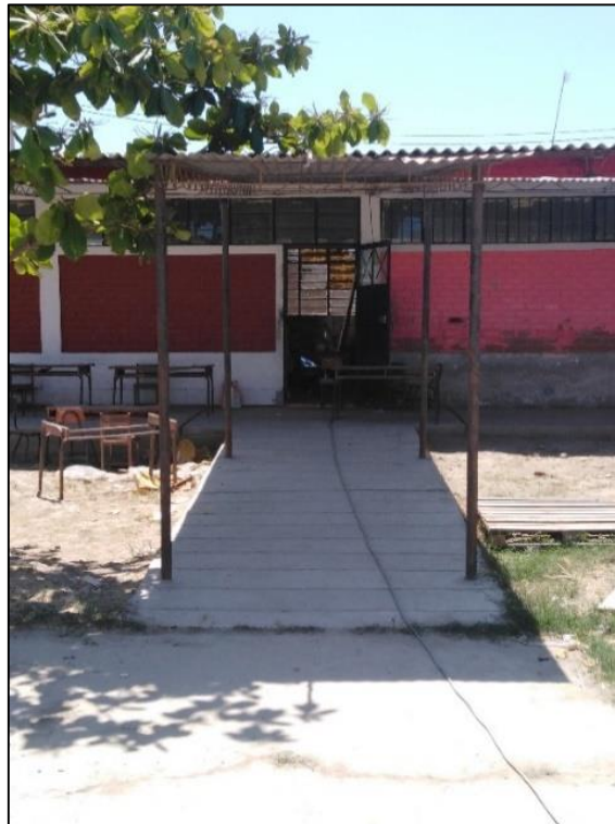
Foto N°01: Las estructuras no han sido contempladas para el fallo de columna corta.
