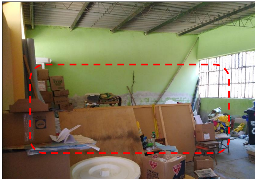
Foto N°03: El ambiente destinado a biblioteca ha sido trasladado a los nuevos módulos. Como se aprecia en la foto el muro ha quedado rastros de la humedad producto de la inundación que sufrió la institución educativa en el 2017 y la altura del rastro es de 1.50 m. En la foto se aprecia cobertura de asbesto cemento, las viguetas son de tubo rectangular y la viga principal es de fierro corrugado soldado. El piso es de cemento. La ventana y puerta son de fierro con vidrio.
