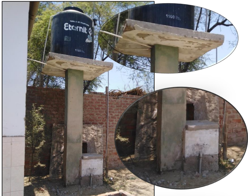
FotoN°14: Su estado es regular presenta los rastros de la inundación, la losa presenta rastros de filtraciones.
