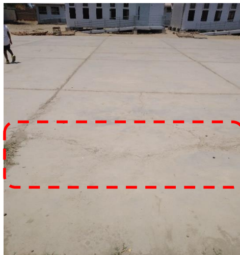
Foto N°13 Se observa el fisuramiento en el paño de la losa de concreto.
