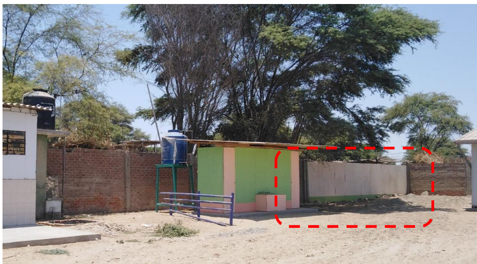
Foto N°18: Los paños caídos han sido cubiertos con triplay.
