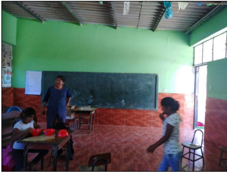
Foto N°02: El almacén del Qali Warma se viene utilizando también como comedor. El piso es de cerámico y cuenta con zócalo a una altura de 1.30 el mismo que oculta el rastro de humedad producto de la inundación. La cobertura es de asbesto cemento y las vigas son de tubo rectangular de fierro.
