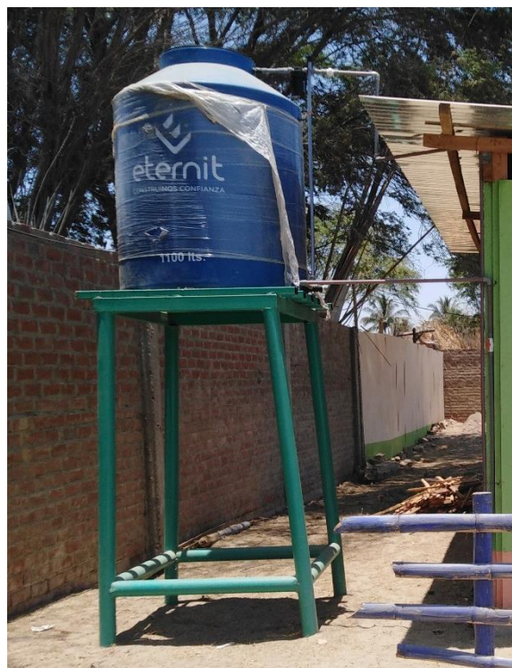
FotoN°15: El tanque elevado 02 es de estructura metálica y el contenedor es de polipropileno. Su estado es regular. Fue adquirido por la APAFA.
