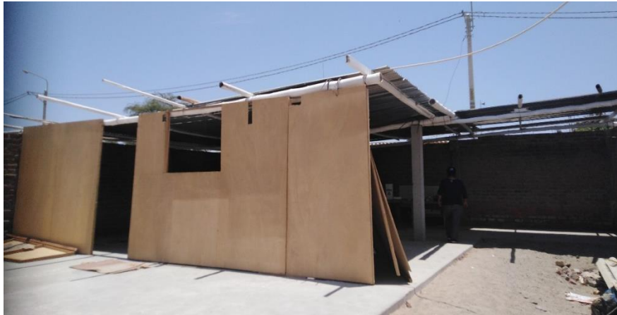
Foto N°11 El módulo de cocina es de material precario (triplay).
