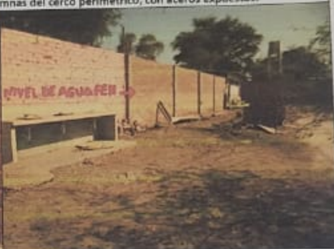
Foto 04: Se aprecia el nivel de agua de inundación por la salida del Río Piura durante el Fenómeno El Niño año 2017, poniendo en riesgo toda la infraestructura de la IE.
