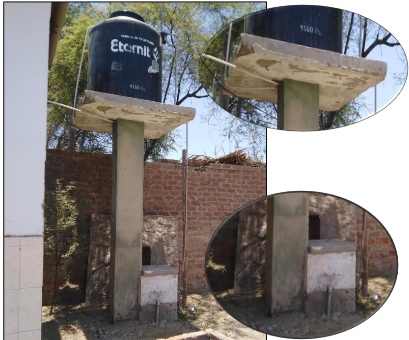
FotoN°14: Vista del Tanque Elevado Su estado es regular presenta los rastros de la inundación, la losa presenta rastros de filtraciones.
