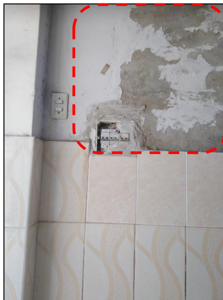
Foto N°07: En la parte interna se aprecia el desprendimiento de la pintura en los muros producto de haber la humedad del muro durante la inundación.
