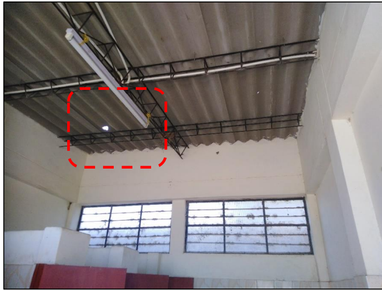
Foto N°08: Las coberturas presentan agujeros.
