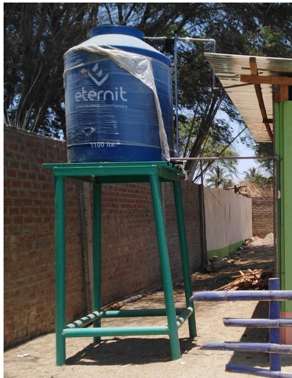
FotoN°15: El tanque elevado 02 es de estructura metálica y el contenedor es de polipropileno. Su estado es regular. Fue adquirido por la APAFA.
