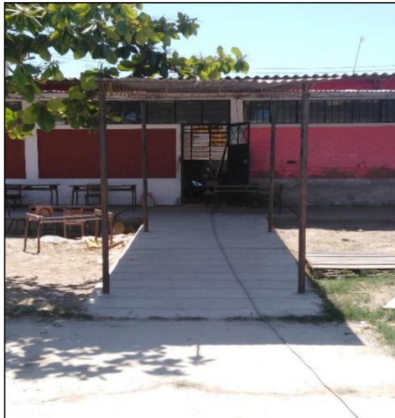
Foto N°02: Las estructuras no han sido contempladas para el fallo de columna corta.
