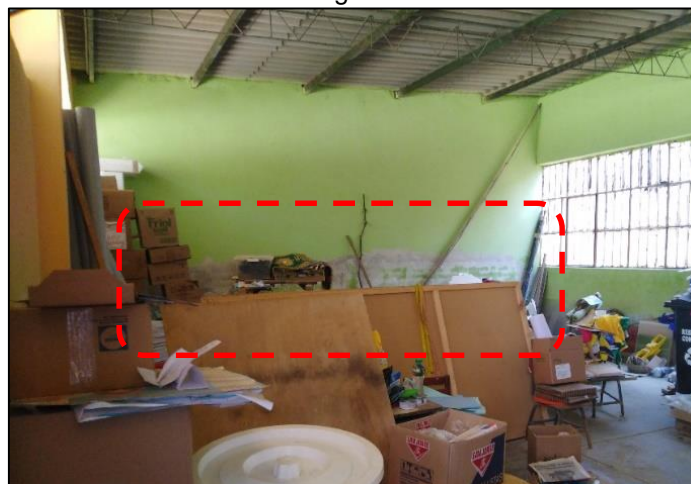
Foto N°04: El ambiente destinado a biblioteca el muro ha quedado rastros de la humedad la altura del rastro es de 1.50 m.
