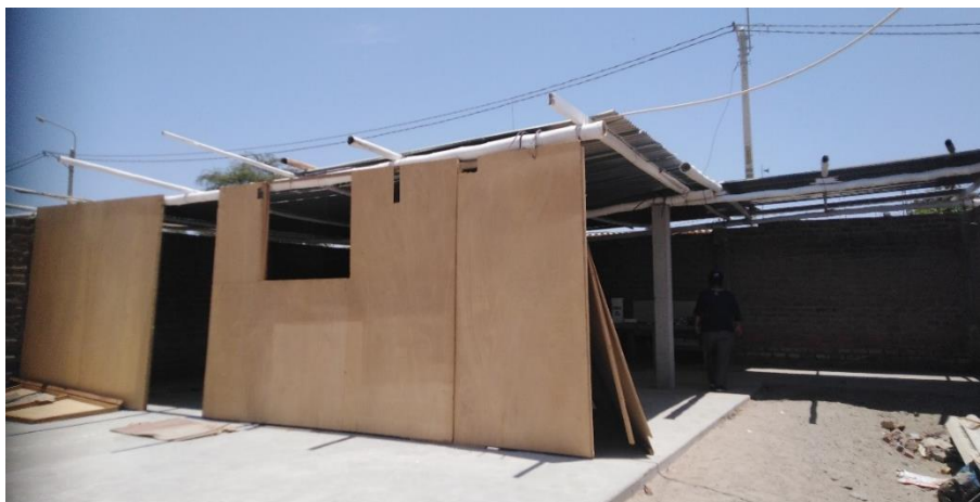
Foto N°10 El módulo de cocina es de material precario (triplay).
