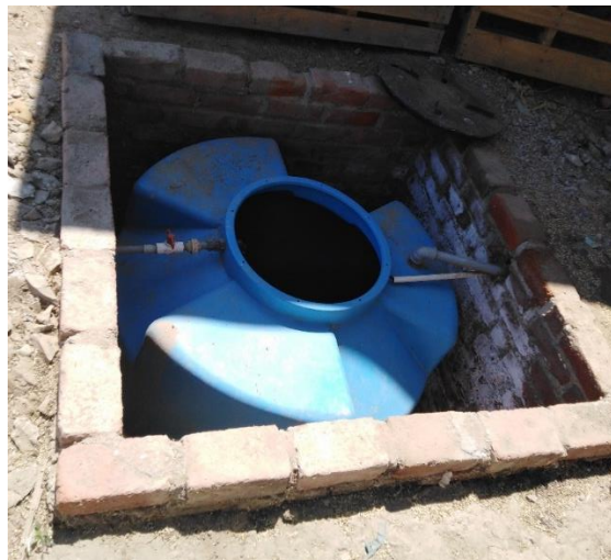
Foto N°13: La cisterna, su estado de conservación es malo. Estuvo inundado en el año 2017
