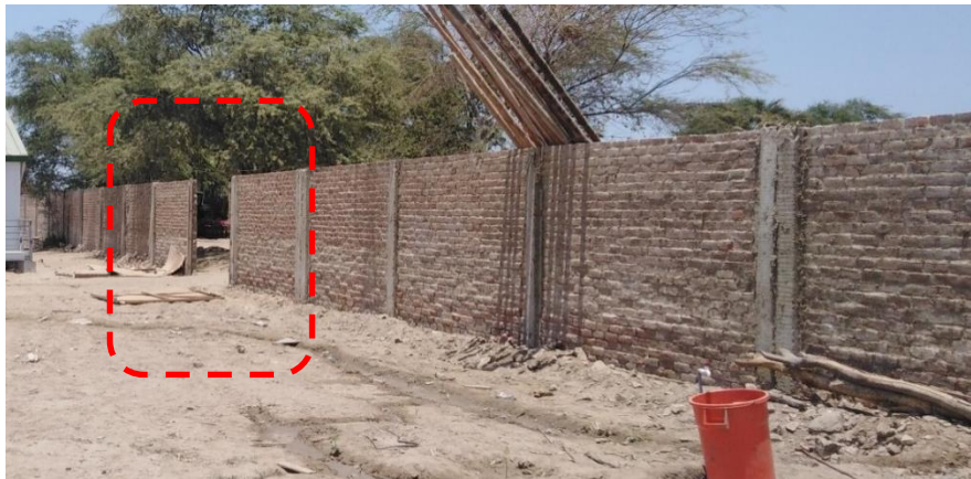
FotoN°17: El cerco de material noble fue construido hace 22 años. Su estado es malo. Como se observa durante la inundación de 2017 se cayeron varios paños.
