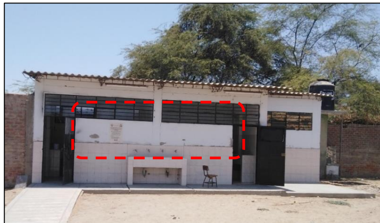
Foto N°06 En la foto se aprecia signos de humedad al desprenderse la pintura en la parte superior del zócalo en los SS.HH.
