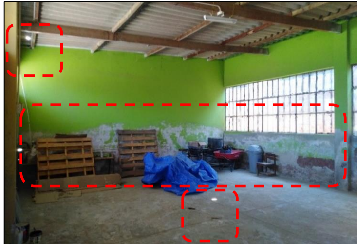
Foto N°05: La Dirección se nota el rastro dejado por la humedad las pizarras en los diferentes ambientes presentan rajaduras. El piso está en mal estado presentando hundimiento y salitre.
