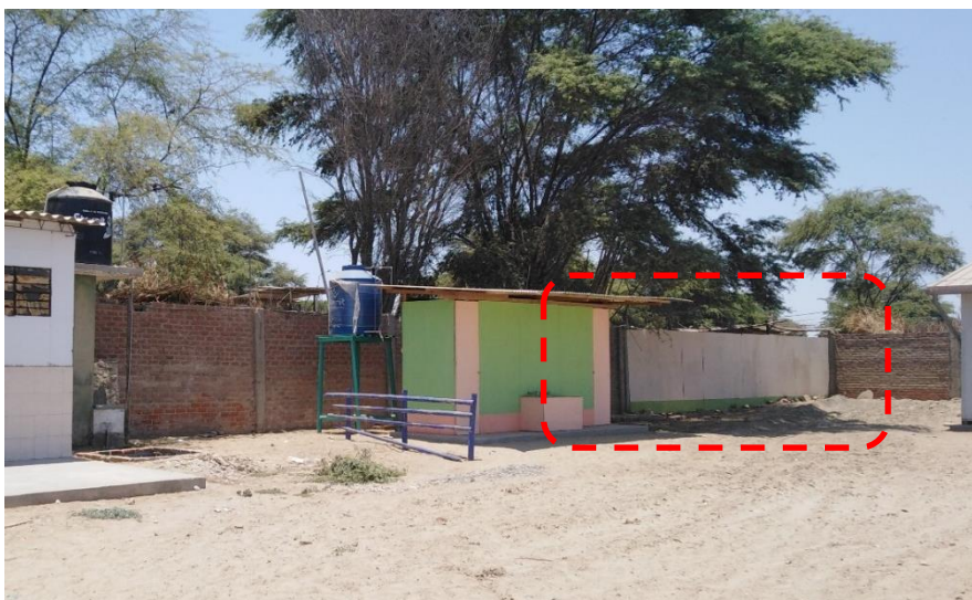
FotoN°18: Los paños del cerco caídos han sido cubiertos con triplay.
