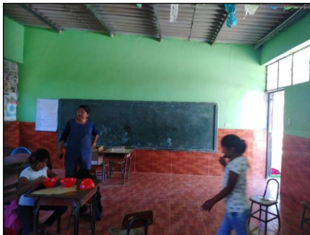
Foto N°03: El almacén del Qali Warma. La cobertura es de asbesto cemento y las vigas son de tubo rectangular de hierro.
