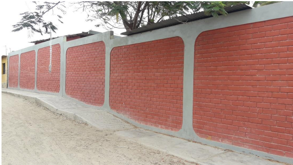
FotoN°15: Es de material noble construido hace 13 años por la Municipalidad Distrital de Catacaos, su estado de conservación es bueno.
