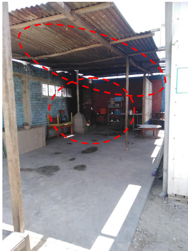
Foto N°09: Las vigas son de Guayaquil La cobertura es metálica y se encuentra en mal estado. El piso es de concreto simple. Los muros se encuentran deteriorados.
