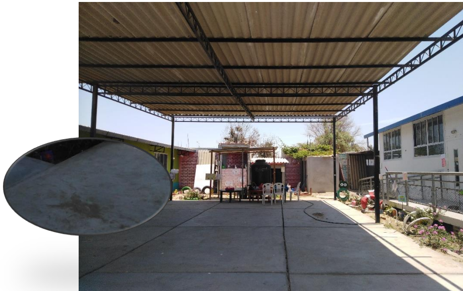
Foto N°10: La plataforma ha sido edificada sobre silo antiguo. El concreto de la plataforma presenta desprendimiento. La cobertura su estado es regular, la estructura metálica presenta buen estado
