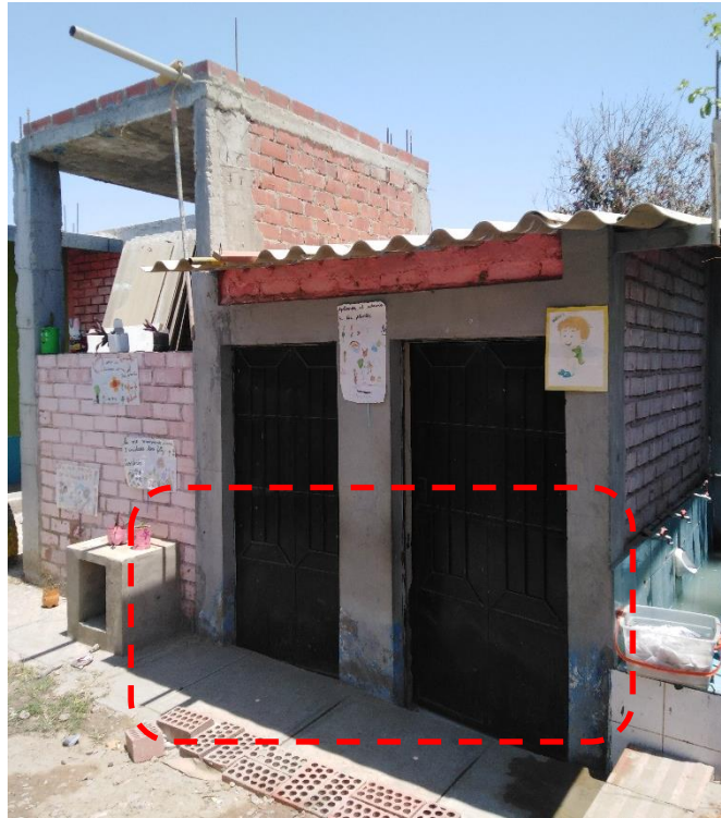
Foto N°07 El baño se encuentra en desuso debido a que el silo se encuentra lleno. Su estado es regular. Este ambiente se encuentra por debajo del nivel de la IE. Corriendo
