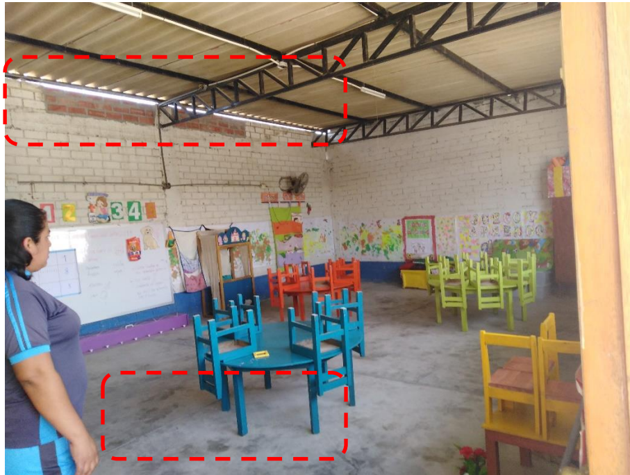
Foto N°03: El módulo utiliza las paredes del cerco como parte del cerramiento, quedando en la parte posterior abertura, que crea filtraciones durante la lluvia. El piso es de concreto simple su estado es regular.
