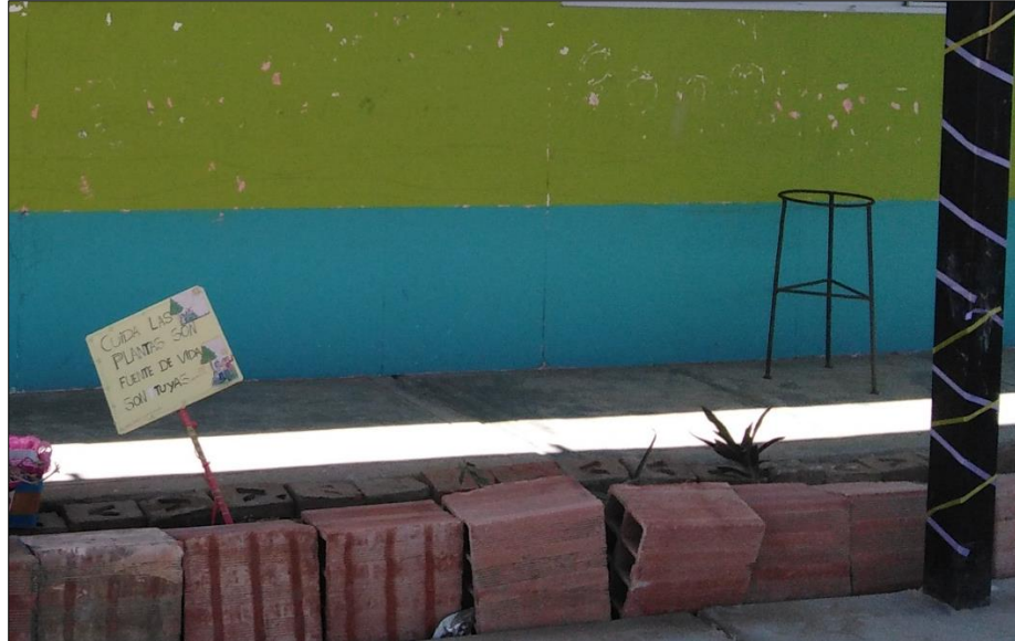
Foto N°11: Presenta deterioro por eventos de lluvia.
