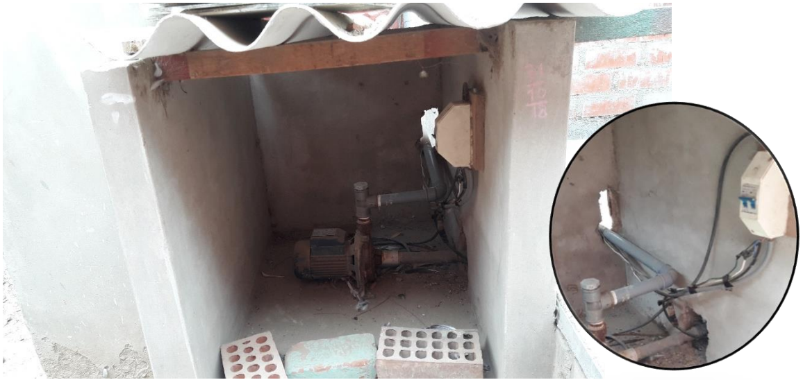
FotoN°14: Se observa la electrobomba de estado de conservación regular. El sistema conexión eléctrico no es de buen estado.
