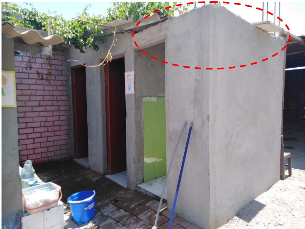
Foto N°08: Se observa que el ambiente proyectado para ducha no tiene cobertura.
