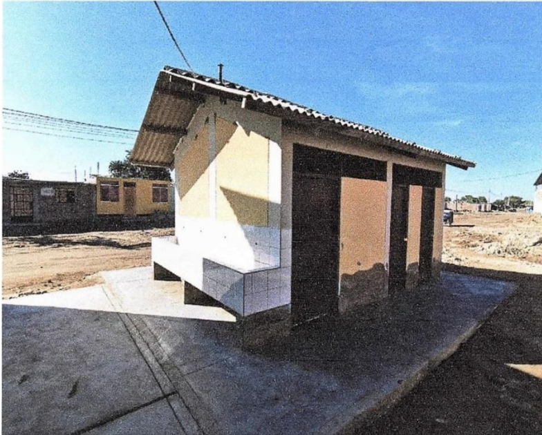
Foto N° 06: Vista de los servicios higiénicos, los cuales se encuentran cerrados, su estado de conservación es regular a malo, el interior se encuentra tarrajado y la humedad ha venido malográndolo, solo se encuentra operativo uno de los baños.
