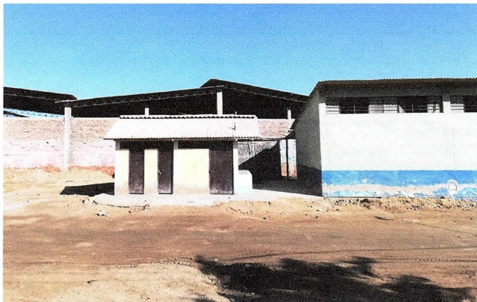
Foto N° 17: Vista desde la calle Leoncio Amaya, se aprecian los bloques de albañilería, el salitre está perjudicando los muros el terreno después de la inundación del año 2017 está siendo mucho más agresivo con las edificaciones, las cuales se mantienen en regular estado debido al presupuesto de mantenimiento, pero es un mantenimiento que no soluciona el problema desde dentro.
