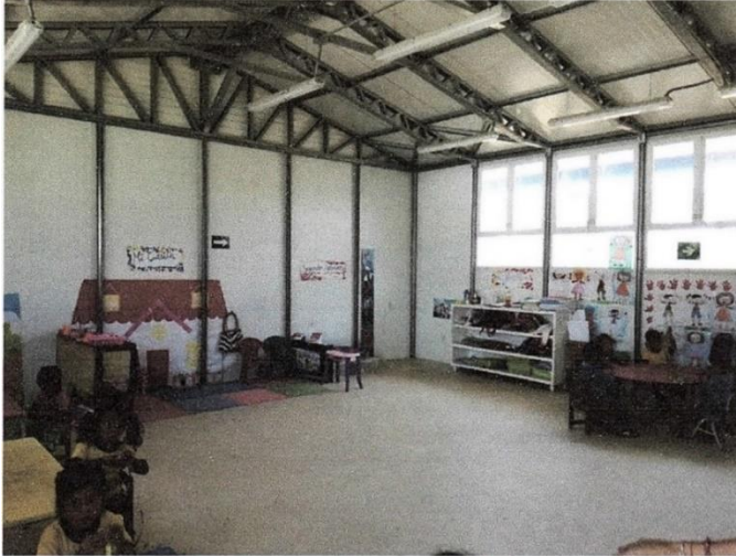
Foto N°01.- El módulo de aula prefabricada se encuentra en regular estado, pero como es sabido es un módulo temporal, por lo que urge su sustitución.
