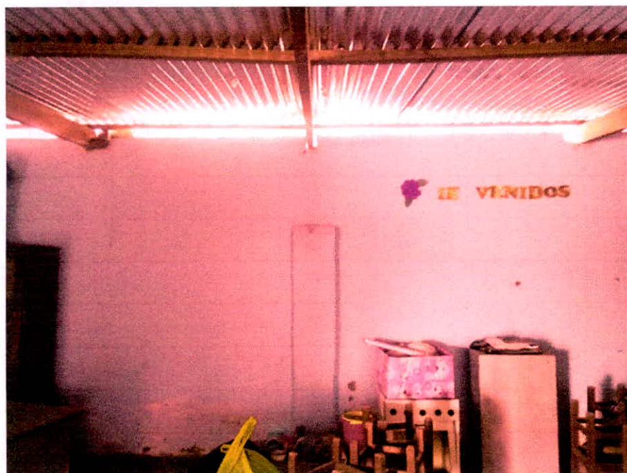
Foto N°05: Vista interior del aula común del módulo 1, se verifica la deformación de la correa de madera, debido a la inadecuada solución de protección frente al periodo lluvioso por parte de la APAFA. También se aprecia que dicho ambiente no cumple con la altura mínima que sumado a la utilización de calamina no genera un espacio idóneo para la realización de actividades educativas.
