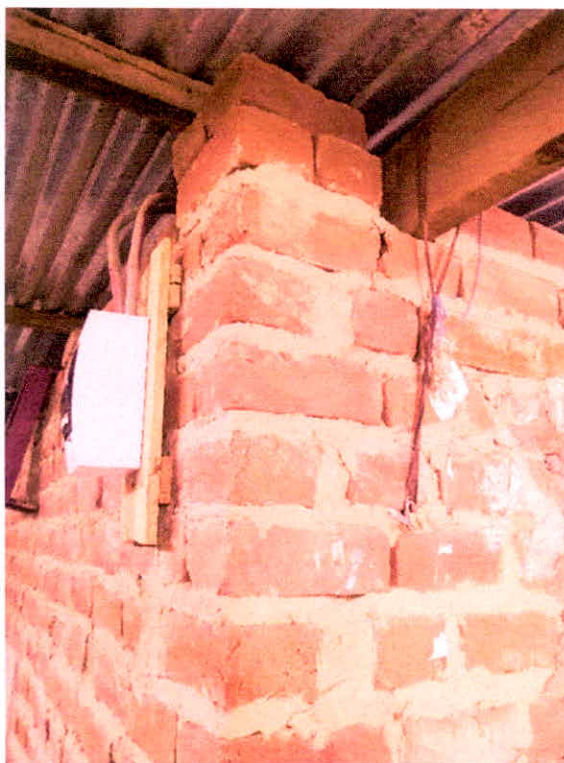
Foto N°04: Fisuras y separación en muro en el encuentro con las correas de madera, en la parte lateral del módulo.
