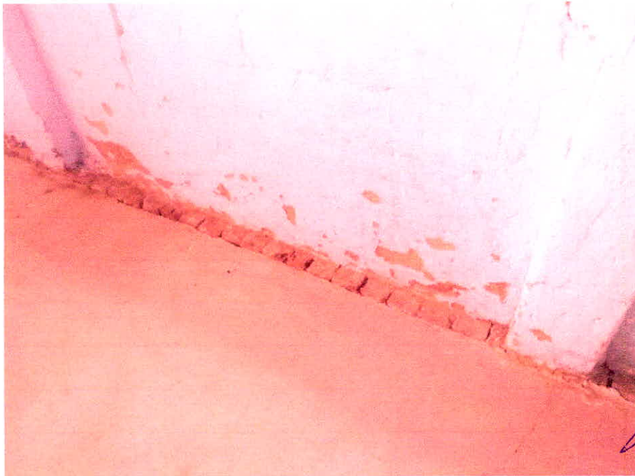
FotoN°03: A pesar de los resanes efectuados por la APAFA, los muros sin confinamiento aparecen deteriorados (fisuras y "calicha miento") en varios sectores del módulo.
