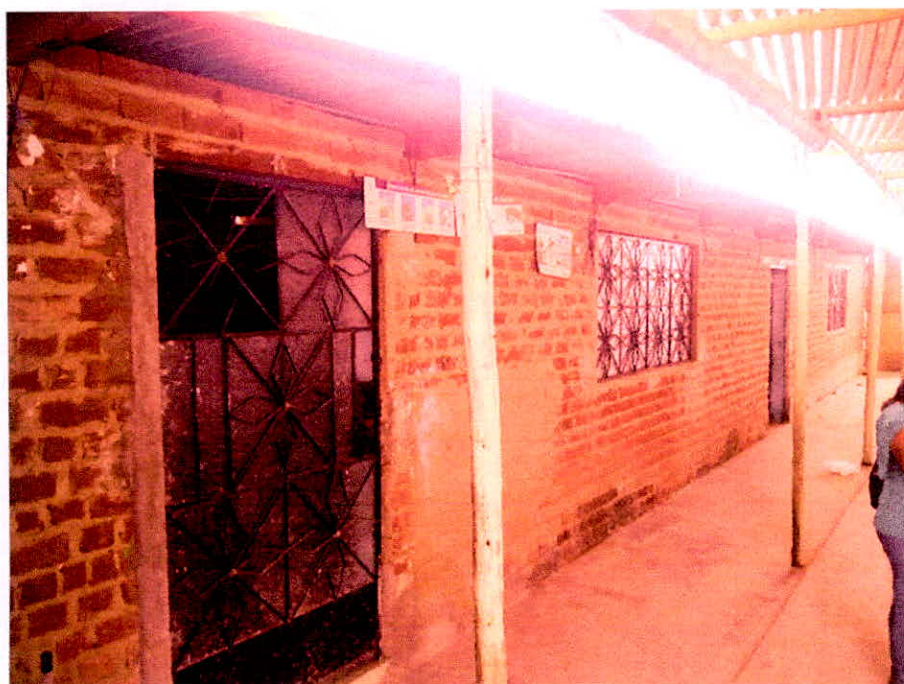
Fotos N°01: Vista de la puerta de ingreso al aula 01 con problemas estructurales puesto que los muros de ladrillo artesanal no poseen elementos de confinamiento. La cobertura de calamina genera filtraciones por lo que el deterioro de los muros se agrava.
