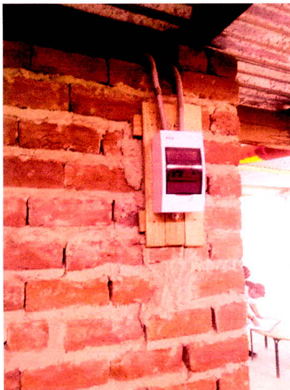
Foto N°11: Instalaciones eléctricas mal diseñadas, expuestas y constituyen un peligro a los usuarios. Otro hecho saltante es que este local no posee suministro eléctrico.
