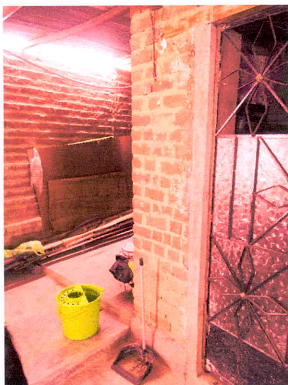
Foto N°07: Puertas metálicas con vidrio crudo afectadas por la corrosión ocasionadas por la humedad que, si bien se ha tratado de darles mantenimiento, pueden ocasionar situaciones riesgosas para los alumnos.
