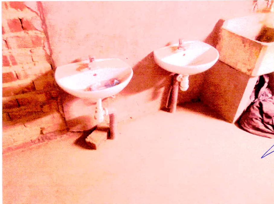
Foto N°10: Batería de 02 lavatorios y 01 lavadero para el uso de niños, el cual no se adecúa a la normatividad.
