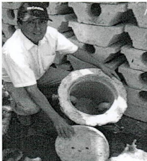
FIGURA. N°04: Retiro de la trampa de grasas de la cocina para la limpieza.
