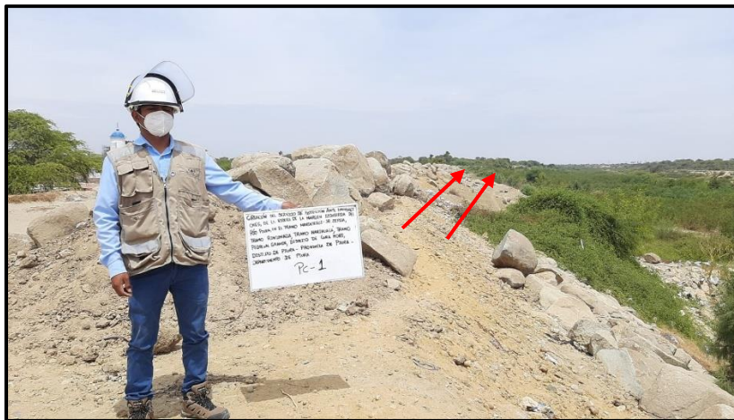
FIGURA N° 12: Erosión de Riberas
