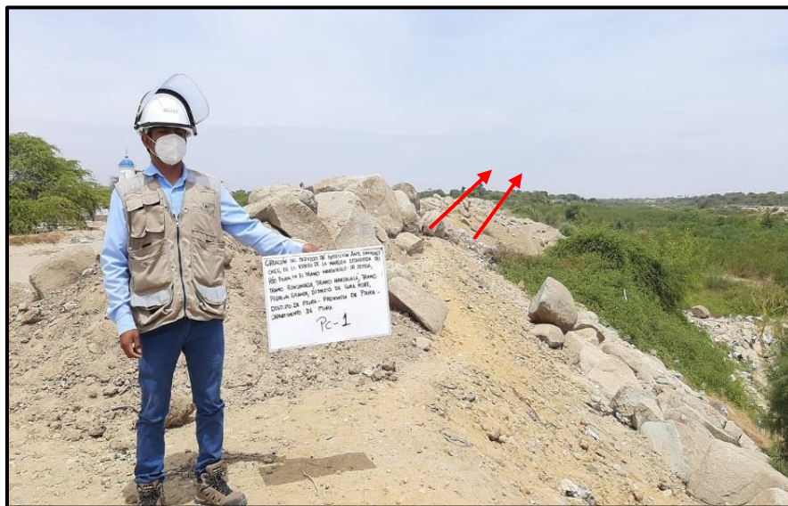
Fotografía N° 5: Erosión de Riberas
