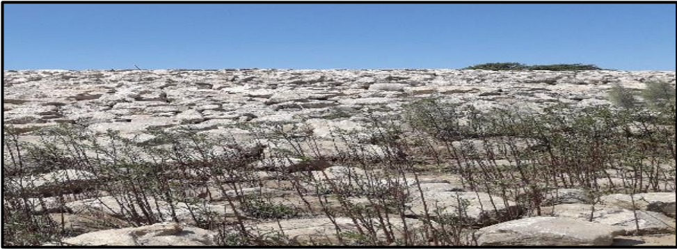
INUNDACION, EROSION DE RIVERA Y SOCAVACION
